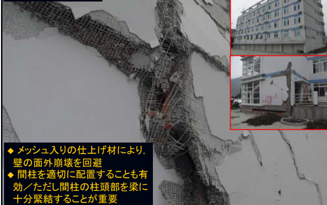
(4) 煉瓦壁の被害
