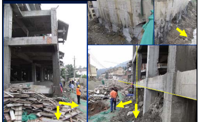
(5) 地盤変状に伴う構造被害
