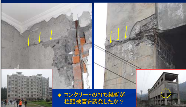
(3) コンクリートの打ち継ぎと柱頭被害／ Column Failure at Construction Joints
