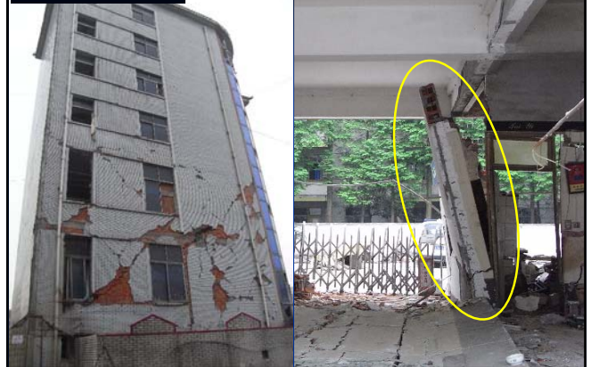
(4) 煉瓦壁の被害
