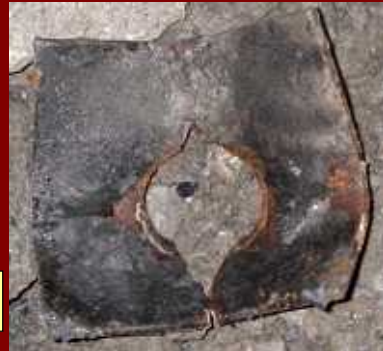
変状したロックボルトと ベアリングプレート
