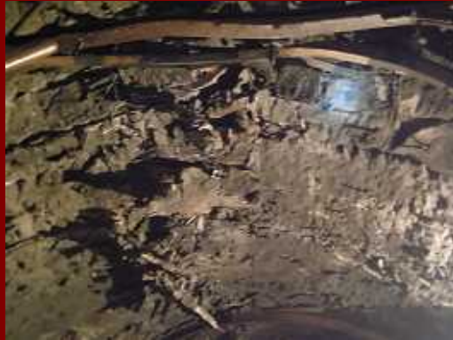
吹付けコンクリートの破壊(天端)
