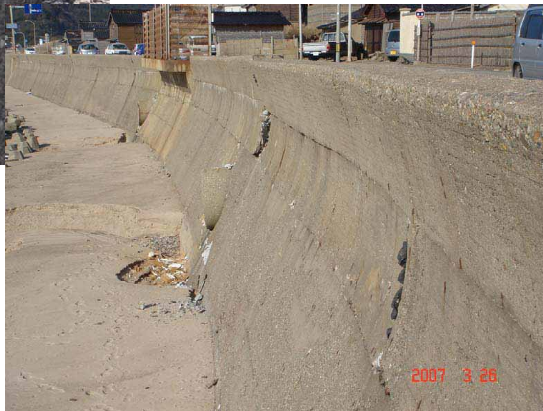
輪島市国道249海岸道路盛土の沈下
