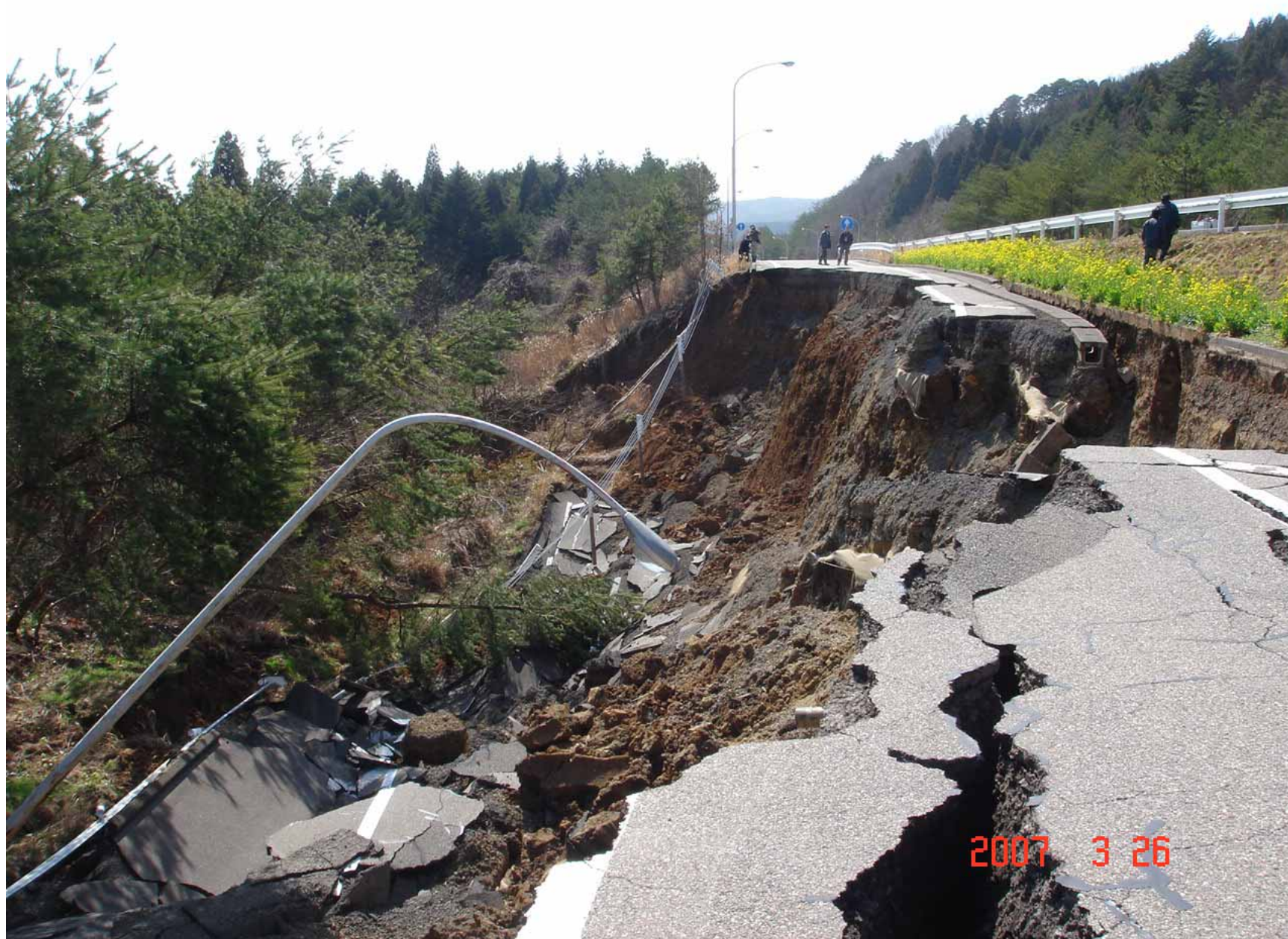
能登道路横田料金所付近盛土崩壊
