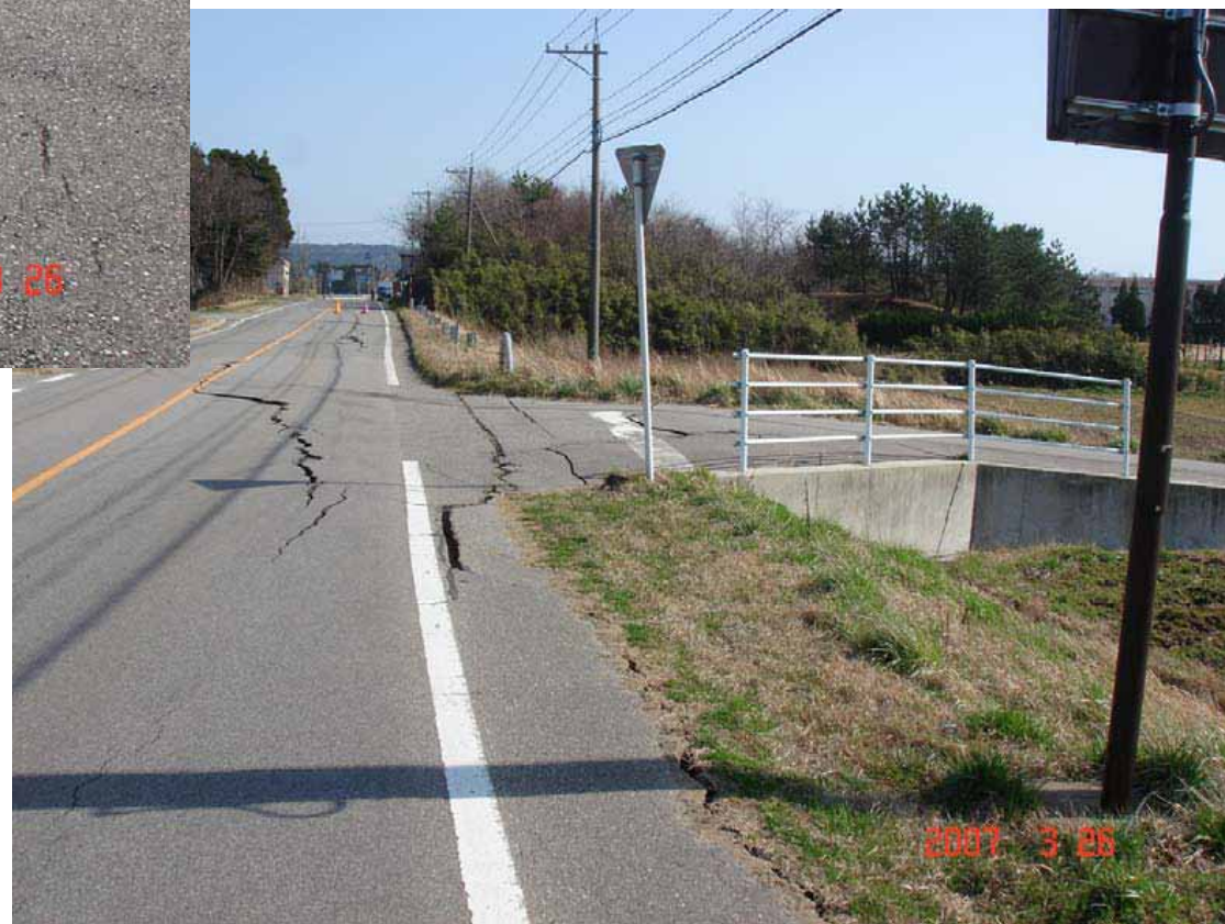
富来中浜道路盛土亀裂沈下
