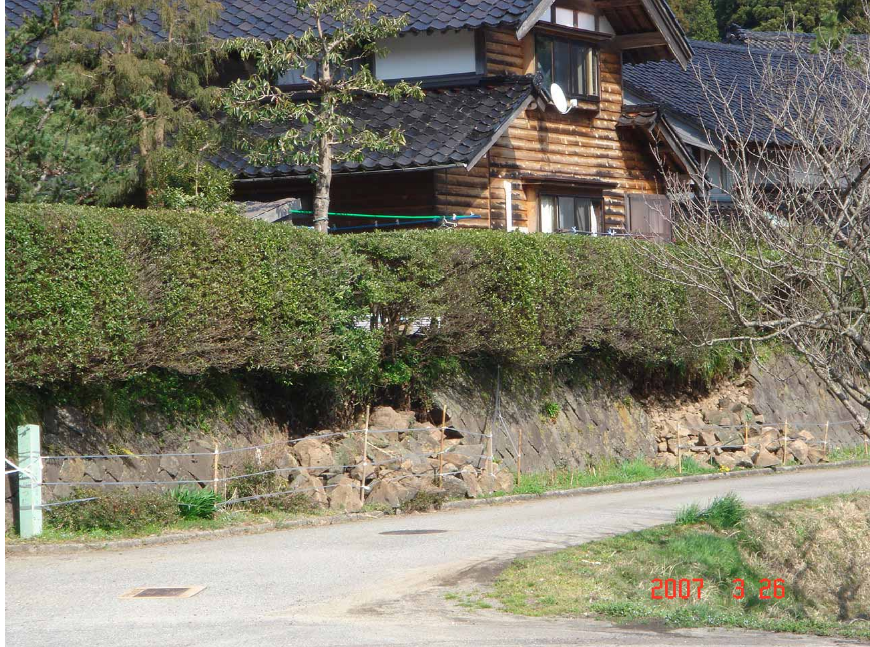
富来付近空積み石垣崩壊
