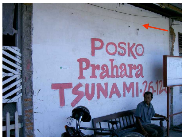
写真-3 ムラボーのモスク横の建物に今も残る津波痕跡 (4° 8' N, 96° 8' E)
