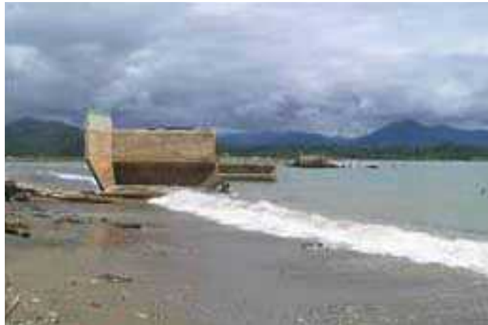
写真-4 ラム ベウソ橋梁 (No. 15) の被災状況 (5° 3' N, 95° 20' E)
