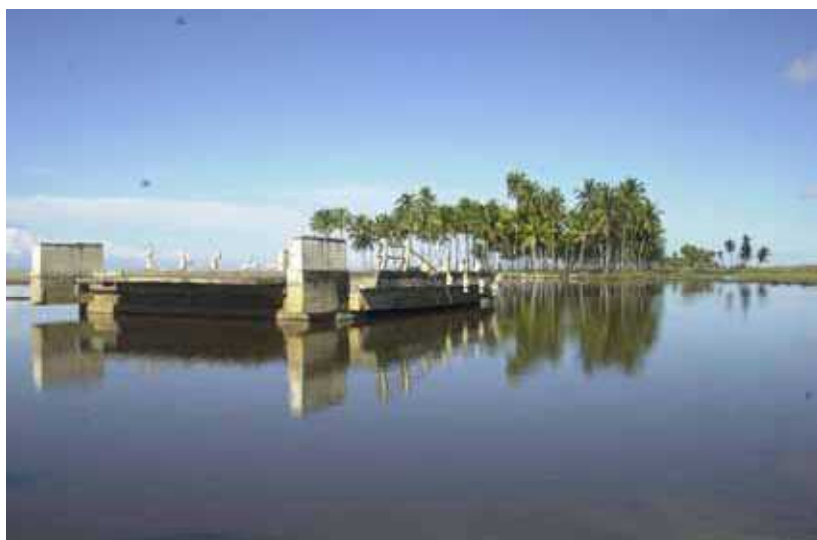
▲橋台と桁の一部だけが残されているが、周辺地盤は沈下し道路も水没している。
