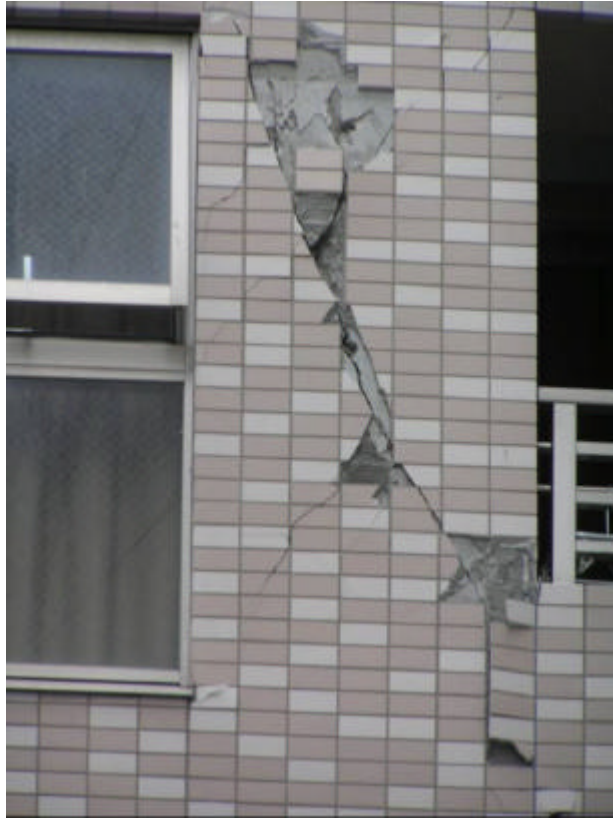
写真 - 3 柱の損傷
