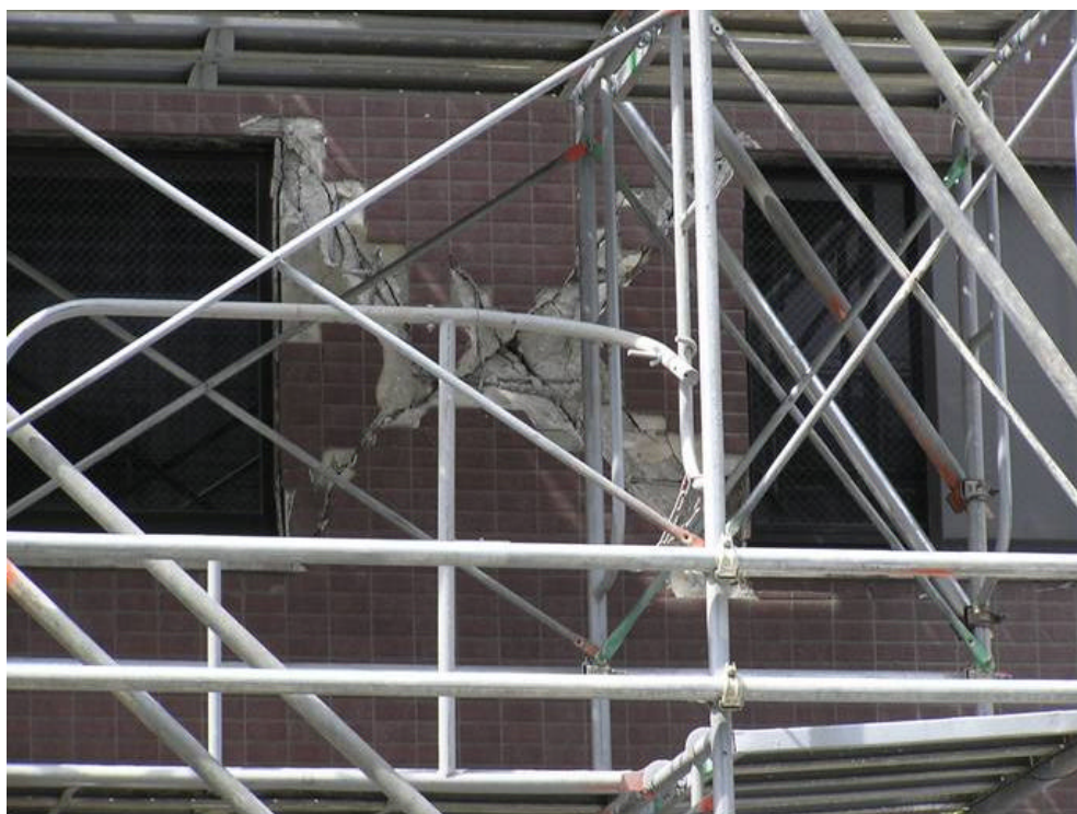
写真 - 2 壁の損傷
