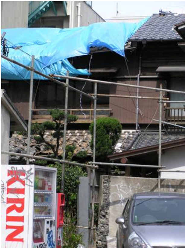
写真 - 4 木造家屋損傷
