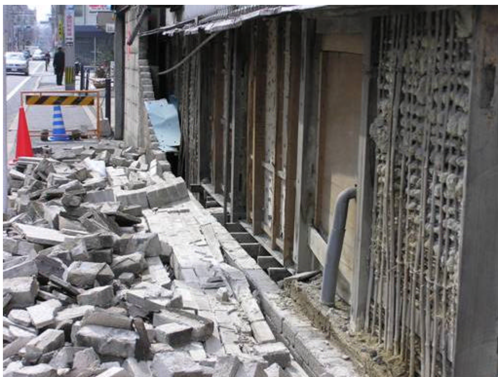
写真 - 5 ブロック塀倒壊
