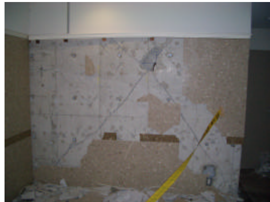
図-10.2 エレベータホールの壁のせん断亀裂
