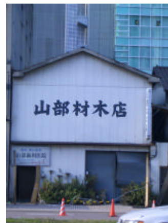
図-10.6 倒壊の恐れがあるため周辺まで避難勧告が出された材木店
