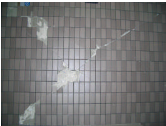
図-10.3 住居部分の壁のせん断亀裂
