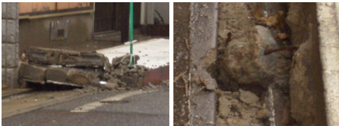
(a)ブロック塀倒壊の様子
