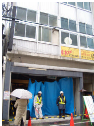
図-8.4 大名の倒壊恐れのあるビル
