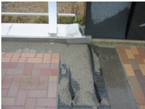
( c ) 橋梁端部の目地と高欄カバ - 破損
