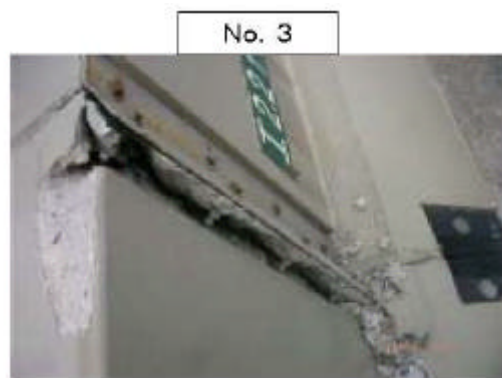
(b) 止水板損傷・壁高欄端部コンクリートの損傷
