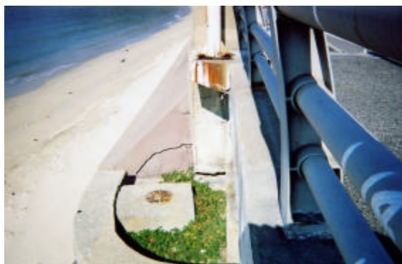
( b ) パラペット部の沈下とひび割れ
