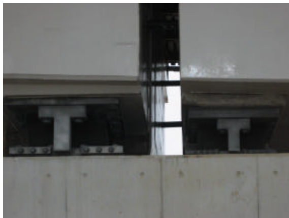
( d ) 橋梁端部の過大な遊間
