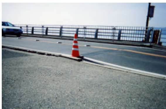
( d ) 橋梁端部の取付け部の沈下による段差
