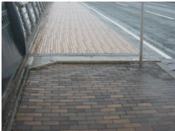
( a ) 歩道の橋梁と取り付け部の段差
