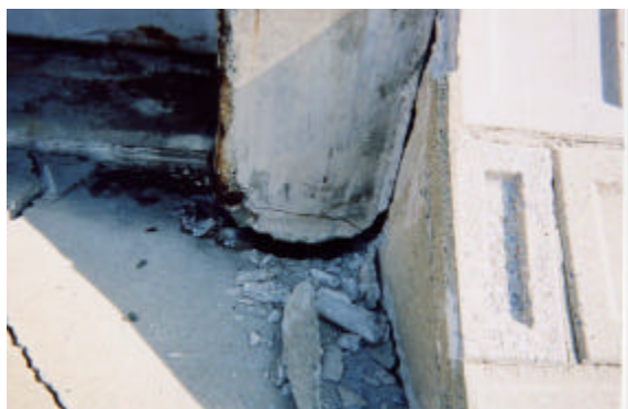
( a ) 橋梁端部パラペット部の沈下とひび割
