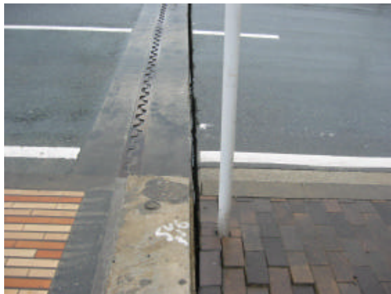
(b)橋梁端伸縮装置と取り付け部の開き
