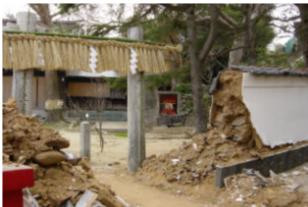
写真 3.2.23 小鷹神社の白壁の崩壊
