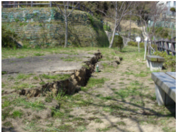
写真 3.2.27 展望台公園の亀裂
