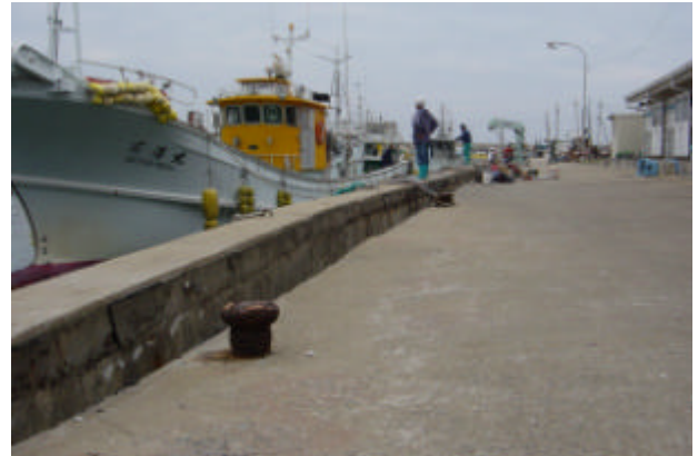
写真 3.2.7 岸壁のはらみだしと沈下
