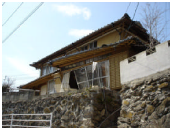
写真 3.2.13 健全な擁壁と損壊家屋
