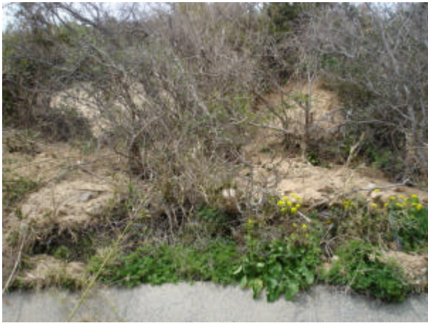
写真 3.2.24 斜面崩壊の例 1
