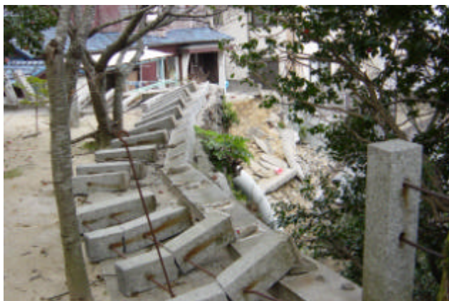
写真 3.2.22 小鷹神社の石造柵の崩壊
