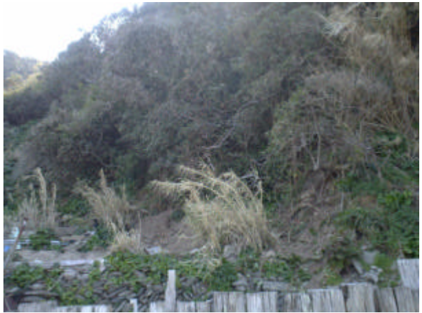
写真 3.2.25 斜面崩壊の例 2
