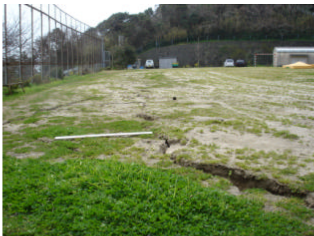
写真 3.2.18 玄界中学校のグラウンド亀裂
