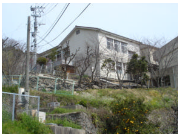
写真 3.2.14 玄界小学校と校庭石積みの崩壊
