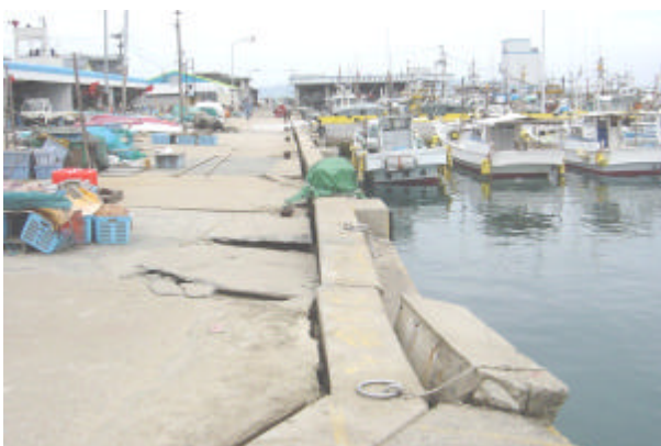
写真 3.2.4 岸壁のはらみだしと沈下
