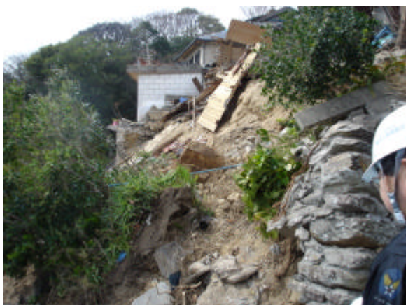
写真 3.2.10 & 11 擁壁の崩壊による宅地流出
