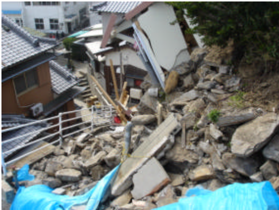
写真 3.2.8 擁壁の崩壊と家屋の倒壊
