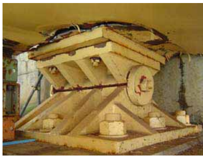
写真 2 支承周辺の損傷
