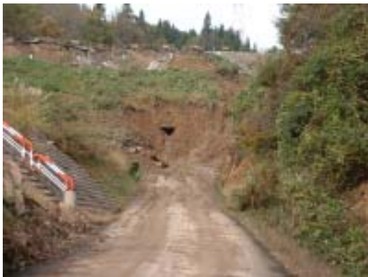
崩壊部を下から見た状況
