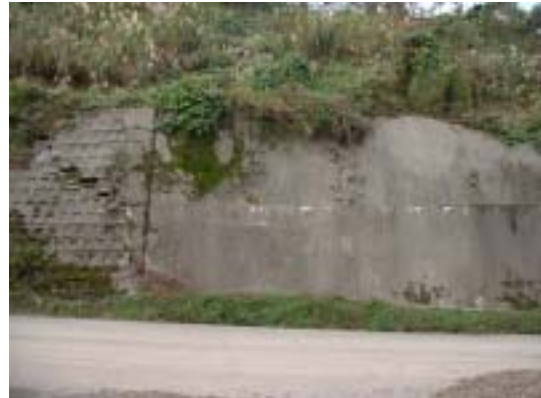
被災したコンクリート擁壁と ブロック積み擁壁
