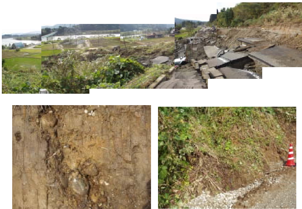
山側に設置された仮設道路の切土からの湧水と小さな沢
