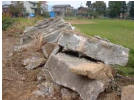
崩落し側道脇に片づけられた ブロック積擁壁（上り車線側）
