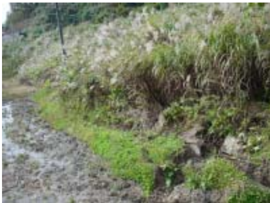
崩壊した法尻部付近
