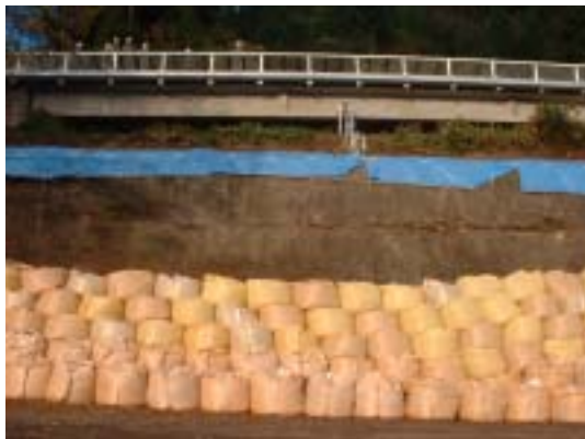
被災したコンクリート擁壁
