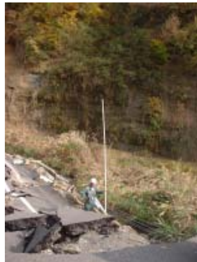
路面の陥没状況
