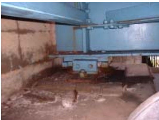
関越自動車道橋台上の沓座の損傷
