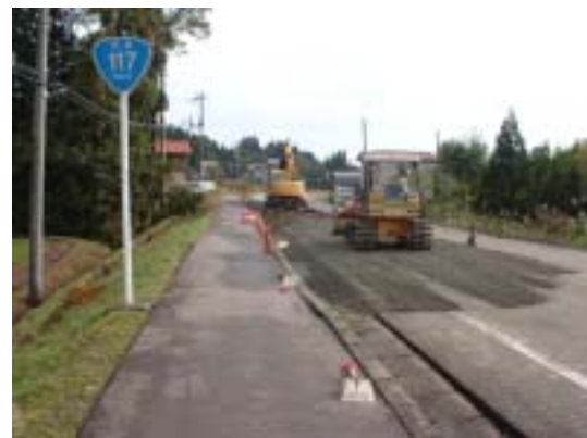
擁壁のはらみだしによる道路の陥没
