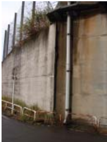
関越自動車道の擁壁の滑動
