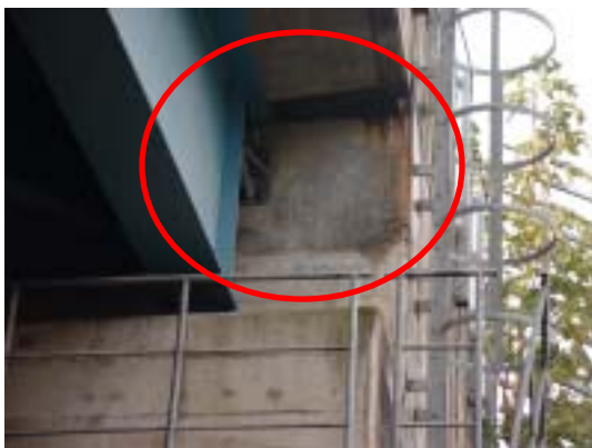
パラペット部のコンクリートの浮上がり
