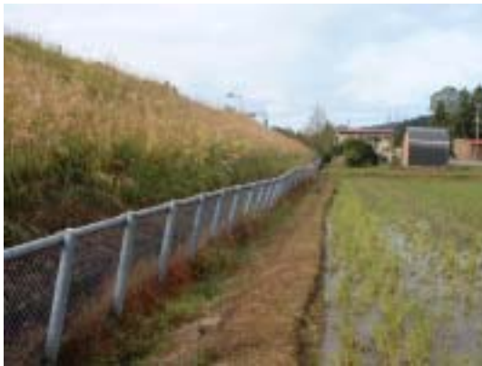
関越自動車法尻部及び田んぼの変状
