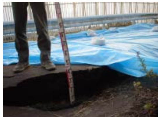
テールアルメ天端のクラック
