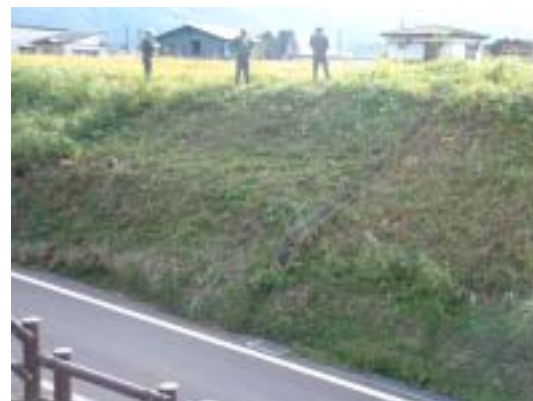
盛土法面の滑り破壊
