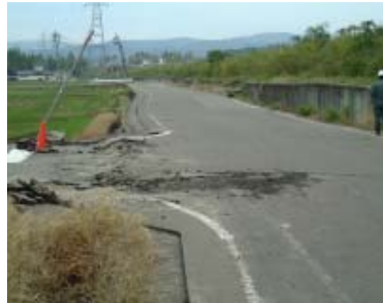
側道部の変状
