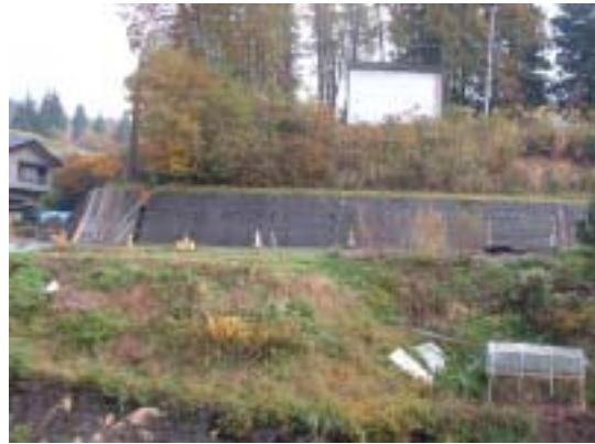
崩壊地の全景
