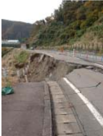
崩壊箇所の全景
