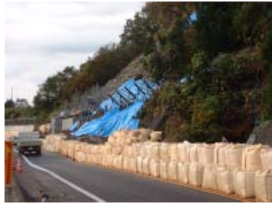
被災したブロック積み擁壁
