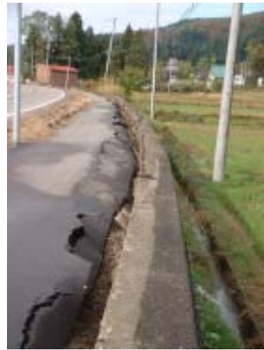
ブロック積擁壁のはらみだし
