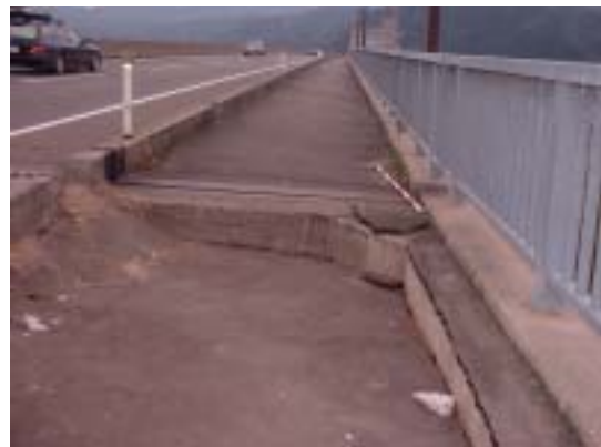
越の大橋歩道部の段差（東京側橋台）
