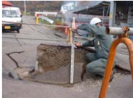
周辺部で発生しているマンホールの浮上がり
