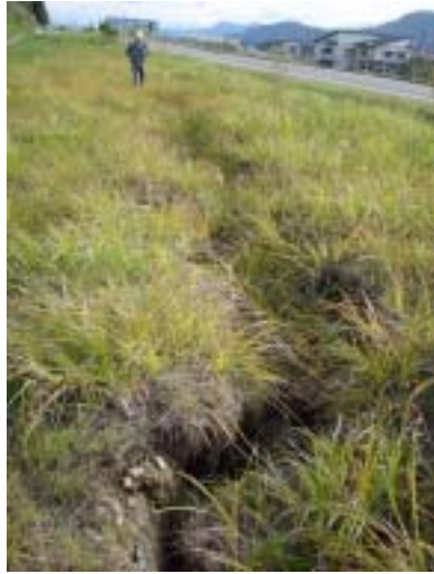
盛土天端で確認された滑りにともなうクラック
