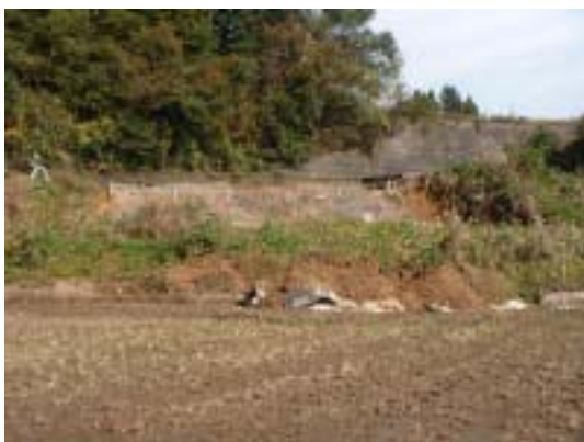
崩壊箇所の全景
