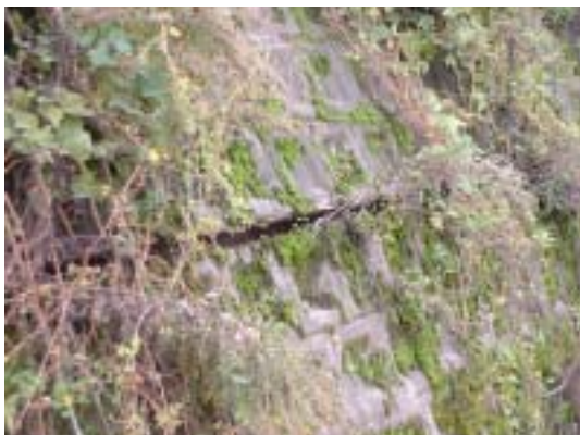
はらみだしブロック積み擁壁
