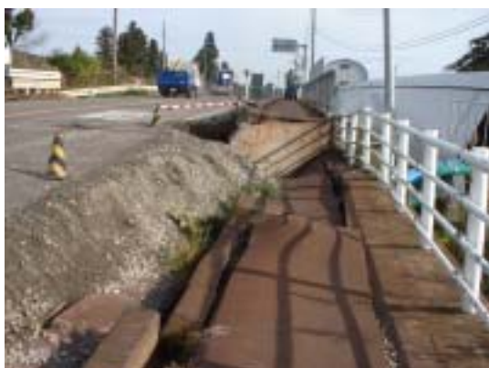
跨線橋取付部の段差
