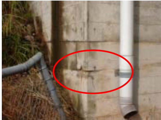
橋台腹面のクラック
