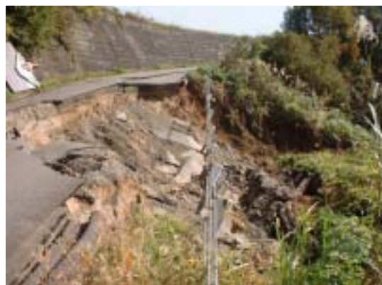
道路崩壊の状況
