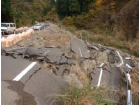
三坂トンネル側の崩壊箇所
