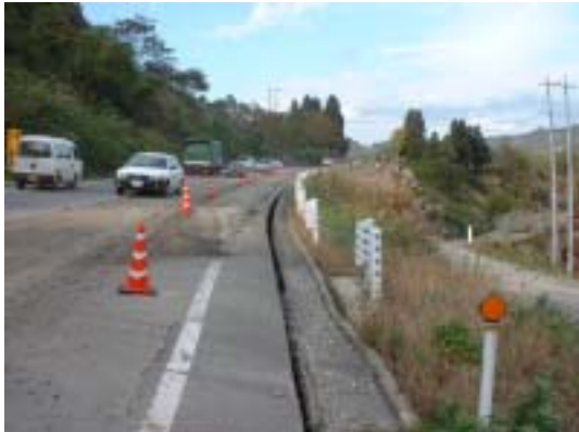
崩壊箇所の全景
