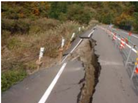
堀之内町市街地側の崩壊箇所
