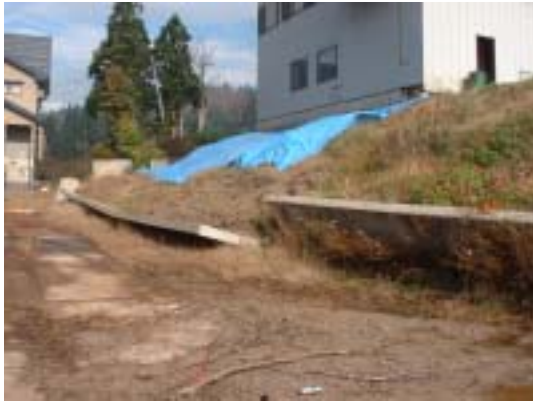
宅地擁壁の崩壊
