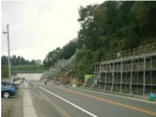
被災したブロック積み擁壁( 10 月 25 日撮影 )
