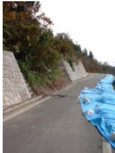
路肩部からの法面崩壊
