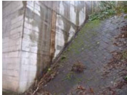
関越自動車道すりつけ盛土の沈下
