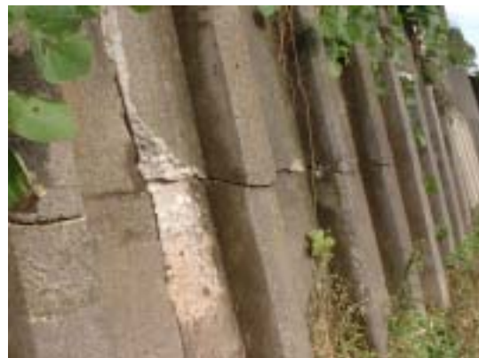
擁壁の損傷状況
