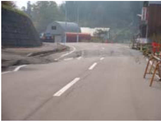
道路陥没の状況
