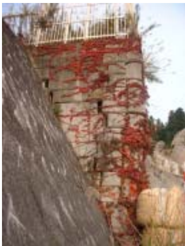
前面にはらみ出したテールアルメ
