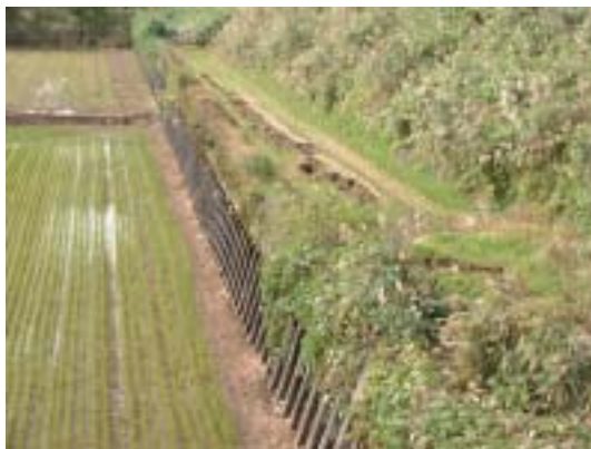
擁壁の滑動により生じた小段のクラック
