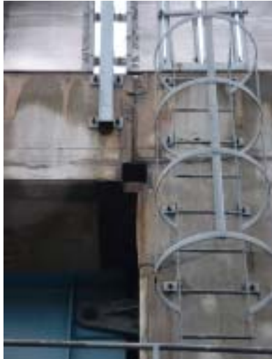
桁端部と橋台の衝突
