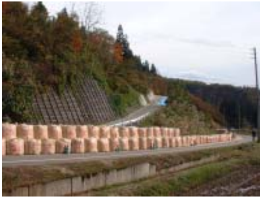
側道法面の崩壊
