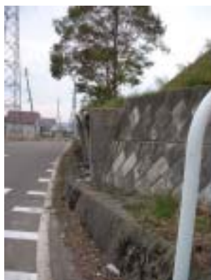
L 型擁壁の傾斜（上り車線側）
