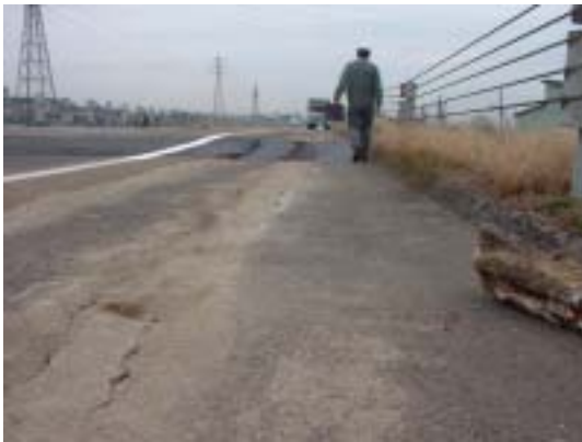
ボックスカルバート部での段差（約 20cm）
