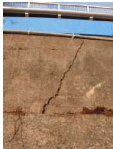
コンクリート擁壁にはいったクラック
