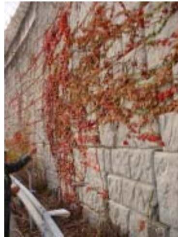
前面にはらみ出したテールアルメ
