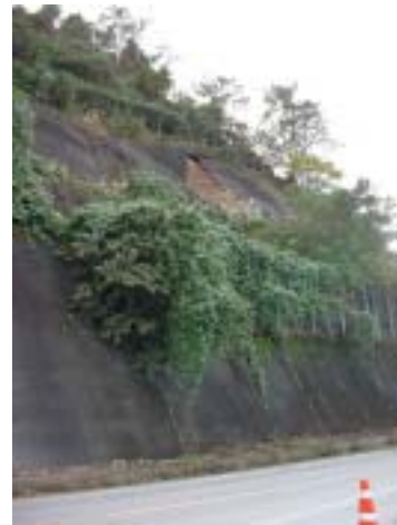
山側のコンクリート擁壁に変状はないが、吹付けコンクリートは一部が剥離や浮上がり確認できる
