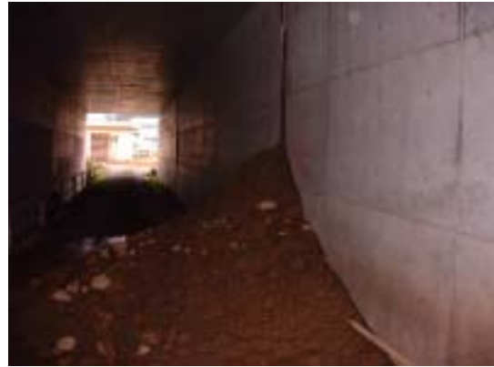
カルバート内に落下した土砂
