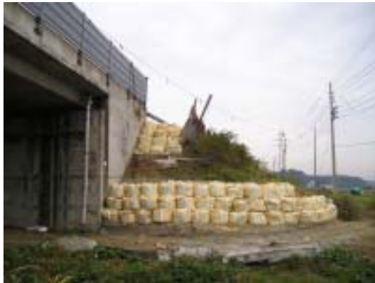
倒壊したブロック積擁壁（上り車線側）
