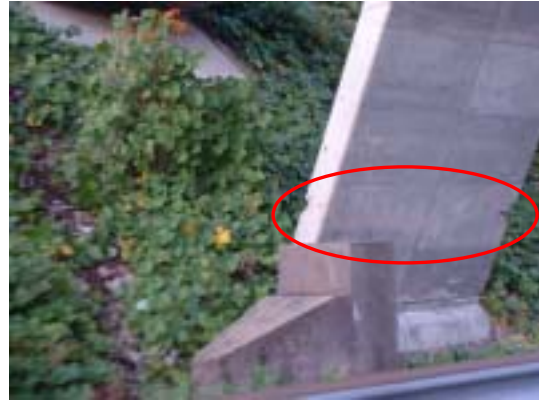
被災したπ型ラーメン橋の鉛直材
