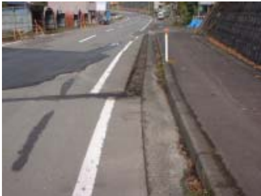
歩道脇に発生している路面の横ずれ
