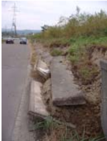
L 型擁壁の崩壊
