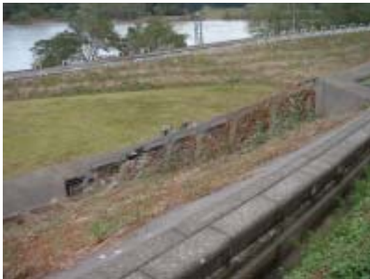
法型枠の変状
