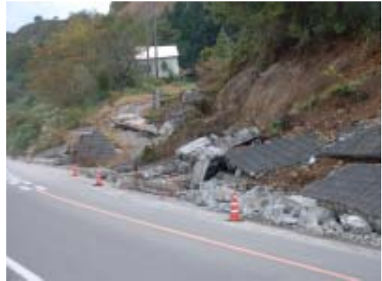
崩壊したブロック積み擁壁
