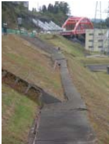
河川側の法面保護の変状
