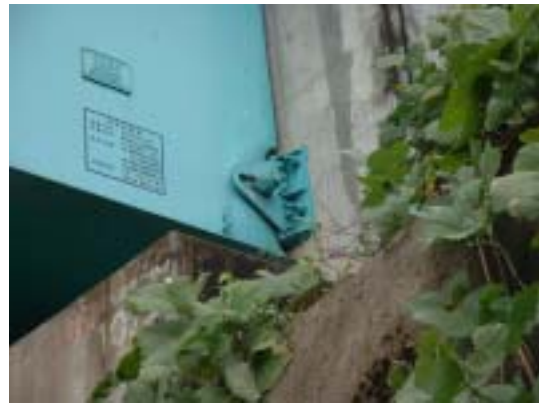
落橋防止装置取付部の変形
