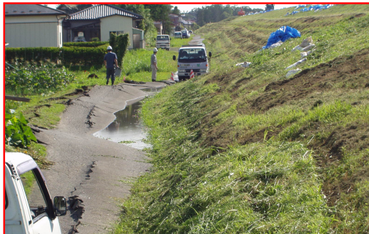
写真 6.7 道路の盛上がりおよび水平変位
