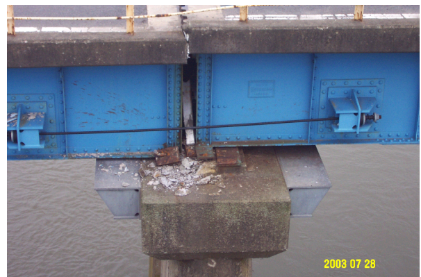
写真 5.2 橋脚上の被災例
