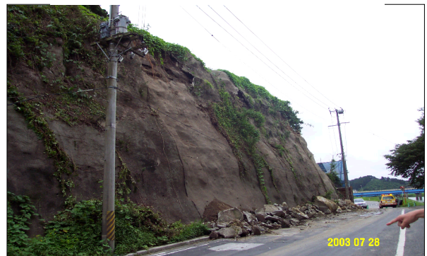
写真 5.5 道路への落石の事例 1)
