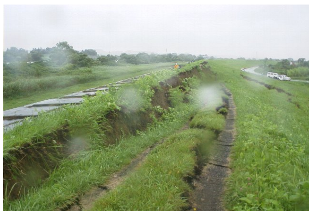
写真10.1 地震発生当日午前10時にホームページ上で公開された堤防の被害状況（第4報）
