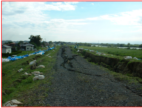
写真 6.6 堤防天端縦断クラックおよび段差
