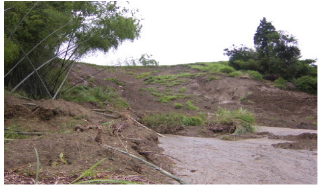
写真 5.4 道路に流出した法面崩壊 1)
