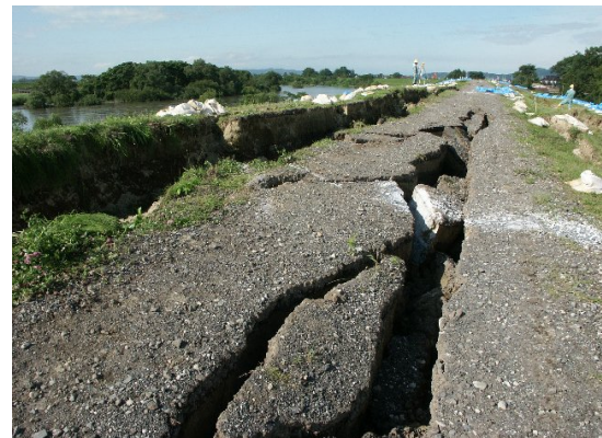
堤防天端の縦断クラック
