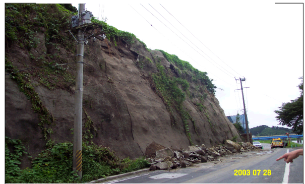
写真 5.5 道路への落石の事例 1)
