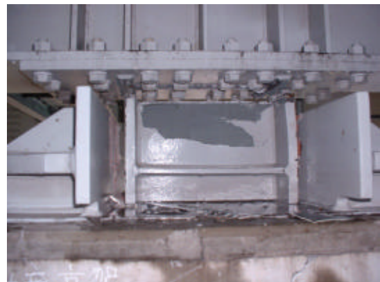
写真-6 多々羅西高架橋移動制限装置の被害(*)
