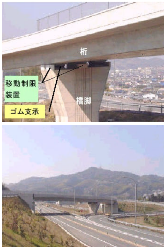
写真-7 今治北I Cランプ橋と被害状況(*)
