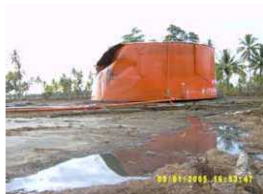
写真-7 被災後のパームオイルタンク
