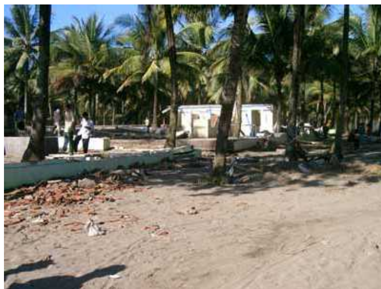
写真-1 ウィダラバユン ウェタンの海浜公園施設の被災 (7° 42'S, 109° 16'E)
