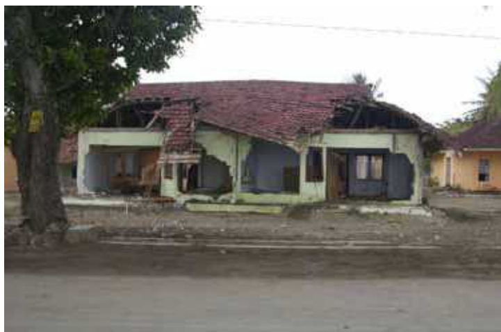
写真-4 パンガンダランの被災状況 (7° 42'S, 108° 39'E)
