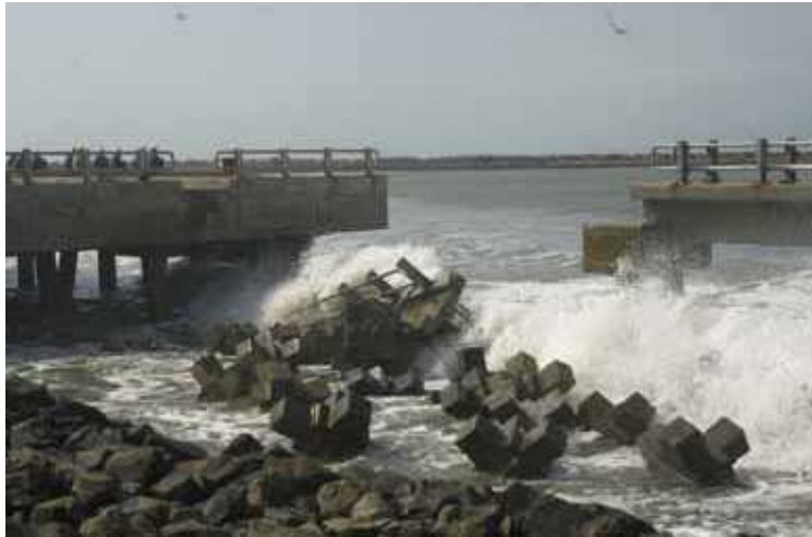
写真-2 カランカドリの火力発電所の被災 (7° 41'S, 109° 6'E)
