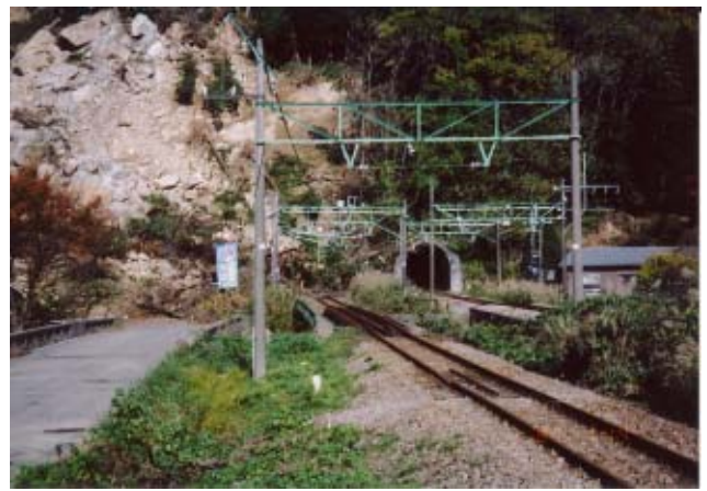
(a) 崩落した岩で閉塞された下り線坑口（左）と上り線坑口：左背面に崩落した白岩層の崖
