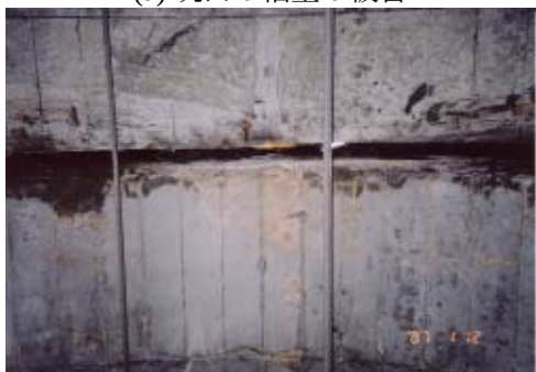
(b) ブロックと袖壁コンクリート間の隙間 図 7.5 牛ヶ島トンネルの被害
