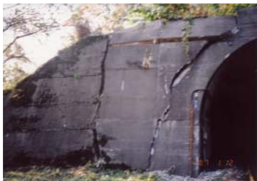
(a) 坑口の袖壁の被害
