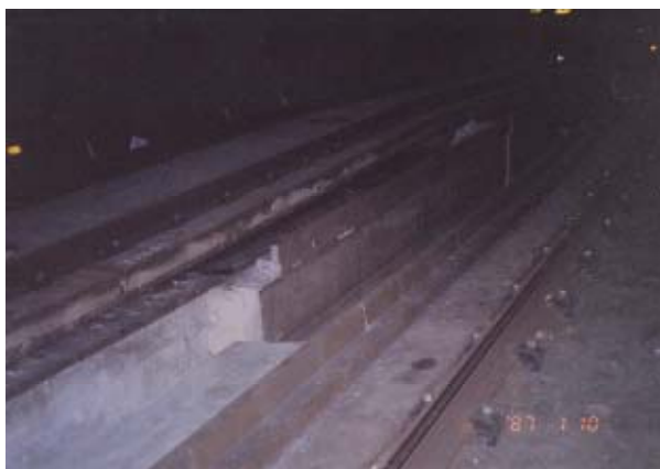
(b) 路盤コンクリート・軌道スラブの浮き上がり
