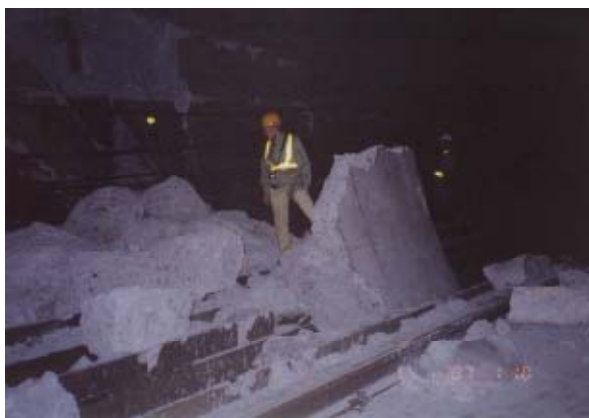
(a) 上り線側覆工コンクリートの剥落
