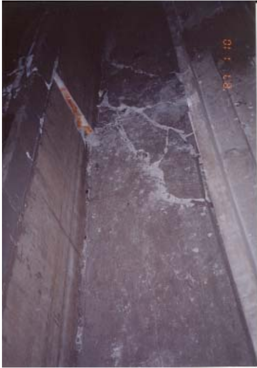
図 7.2 上越新幹線魚沼トンネル東京側坑口より 2.403km 地点での中央通路底面の損傷
