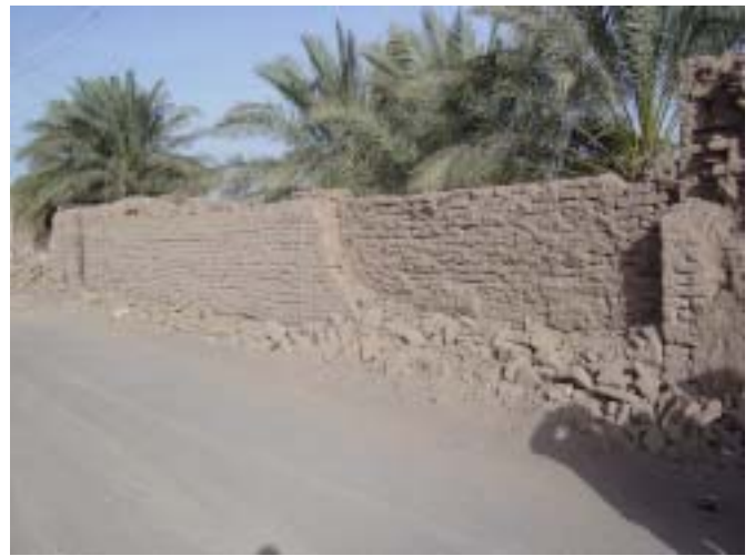
図 9 アドベ造壁の不適切な施工による被害
