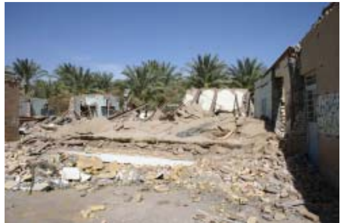
図 11 崩壊したレンガ造の学校校舎
