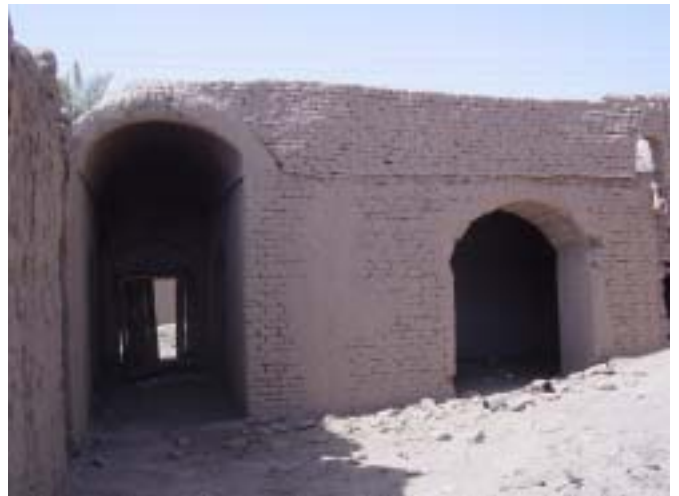
図 3 老朽化したアドベ造建物
