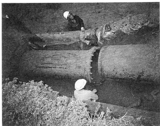
写真-2 配水管φ800K型継手の離脱
