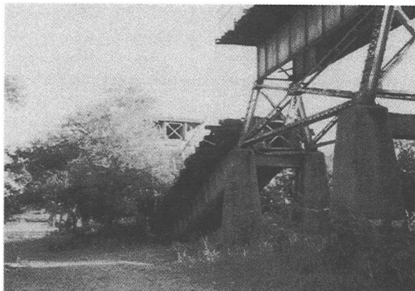
写真-6 レンパ川の橋梁被害
