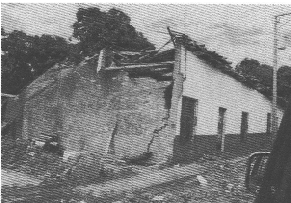
写真-7 レンガ積み住宅の被害 (サンアゴスティン)
