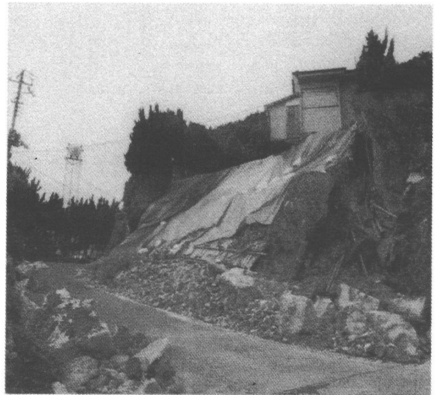
写真-3 石積擁壁の崩壊
