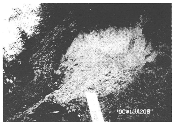
写真-2 伯太町部張での斜面崩壊
