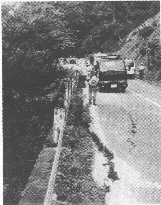
路肩の被害（国道 108 号線中川原付近）
