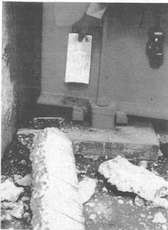
橋台と支承の被害（国道 108 号線中沢橋）
