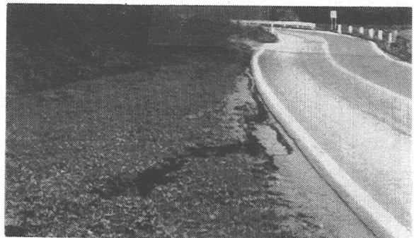
路側の崩落（旧仙秋ライン片倉森付近）
