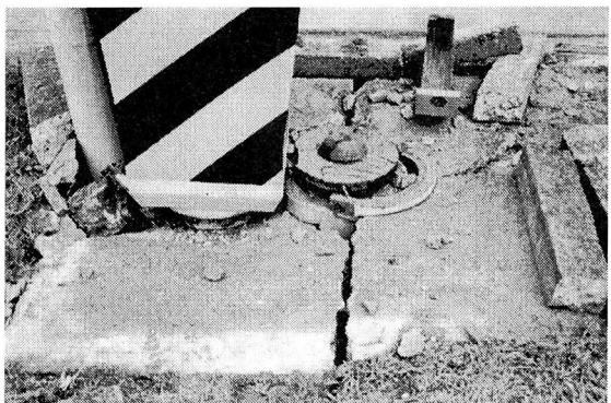
写真-3 ピボットシユの逸脱 (P2)
