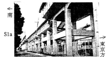
図7 下食満高架橋の変状 5)18)
