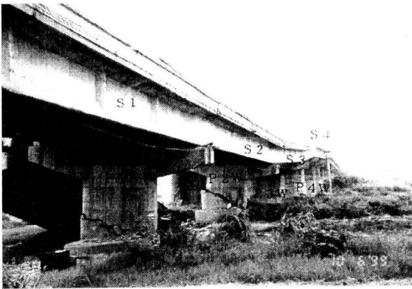
写真-2 鳥浜橋の被害(南下北)
