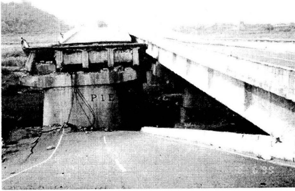
写真-1 鳥浜橋の被害(北上線の桁落下)
