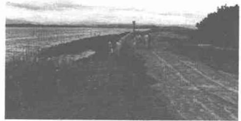
図-5 弓ヶ浜干拓の干拓堤防の被害
