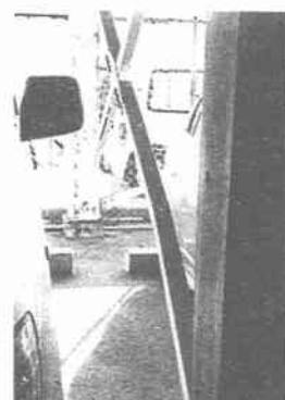
写真2 ブレースの座屈
