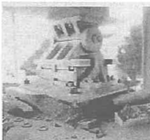
図-2 支承破壊状況
