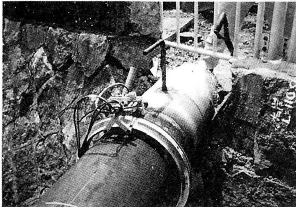
写真-2 右岸側の状況 (神戸市須磨区)
