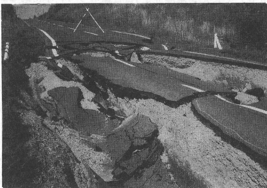
写真-2 切盛り境の被害例 (中標津町)
