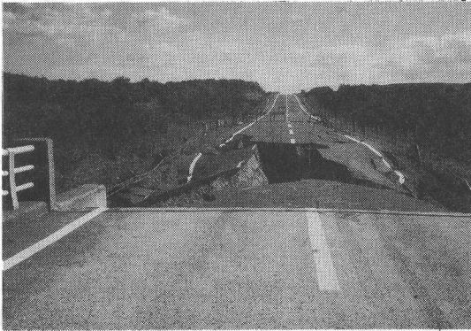
写真-1 橋梁取付部盛土被害例 (別海町美広橋付近)
