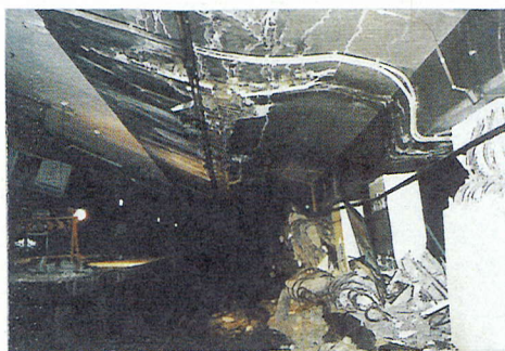
写真-1 大開駅中柱の崩壊
