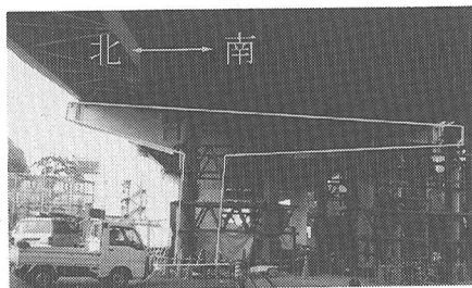
写真-1 P-352の損傷状況
