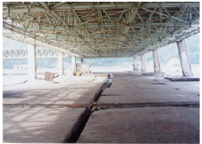
写真2 コンクリートパネルの開き (南から北方向へ撮影)
