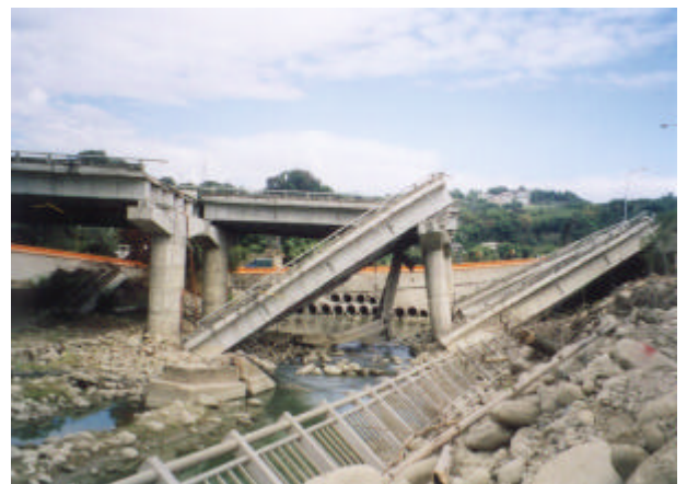
写真-1 石圍橋の被害
