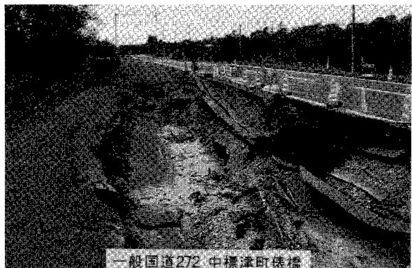
写真-1 盛土被害の概況
