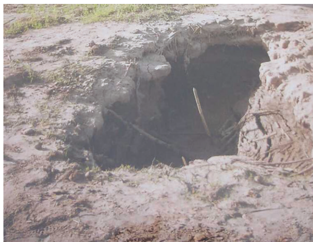
写真-2 Goynuk suyu川の近くの噴砂孔
