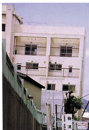
写真-3 傾いたマンション
