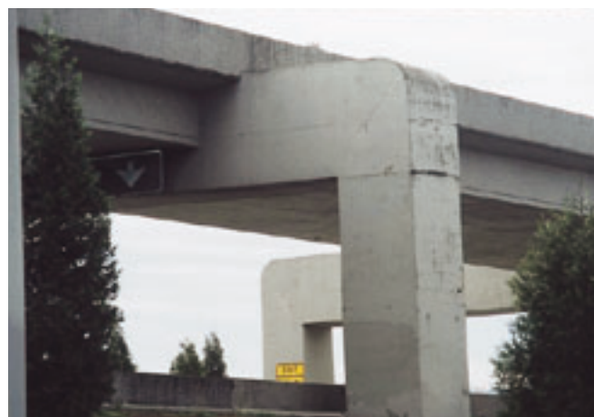
写真-4 アウトリガー式橋脚のクラック（州際道路5号と90号のジャンクション，シアトル市内）
