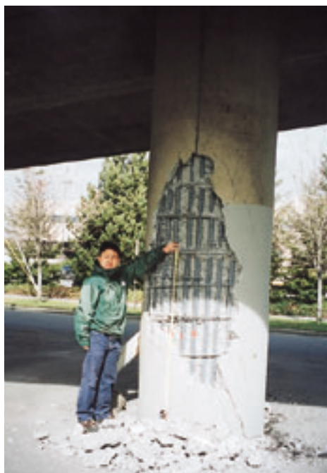
写真-2 RC橋脚の曲げせん断破壊（ホルゲート高架橋の州際道路5号横架部，シアトル市内）
