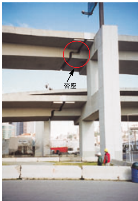
写真-3 構造、剛性変化点で生じた沓座の損傷（州際道路90号へのオンランプ，シアトル市内）
