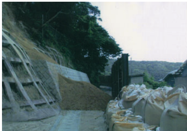
写真-1 神津島・与種地区での斜面崩壊と応急対策（大型土のうと仮囲柵設置）
