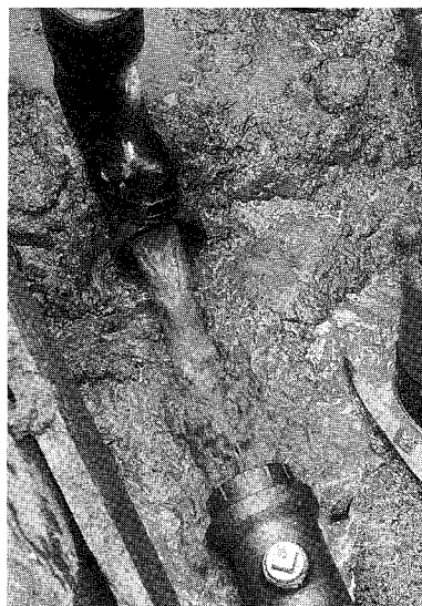
写真-1 ガス管から流れ出す水
