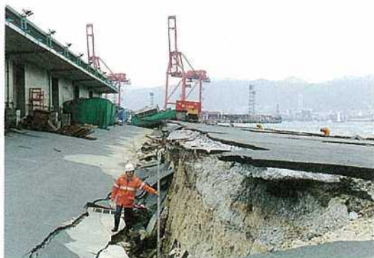
写真-1 ポートアイランドのケーソン岸壁の被害状況
