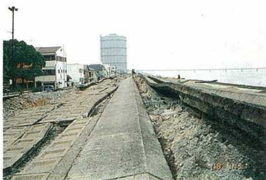
写真-1 崩壊・大破した淀川堤防（西島地区）
