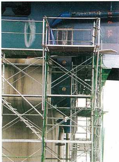
写真-2 第2摩耶大橋における落下防止装置
