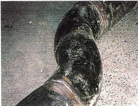
写真-7 ガス管路座屈 (神戸市中央区フラワーロード)
