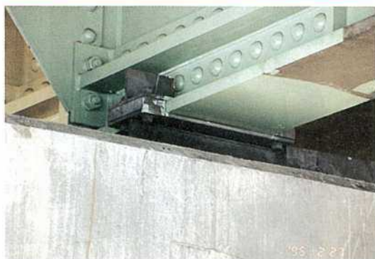
写真-4 阪神池田線豊中付近の免震支承
