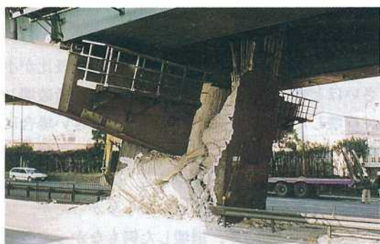
写真-9 単柱式矩形橋脚の崩壊
