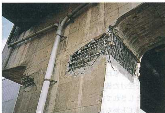
写真—14 曲げ降伏後の鉄筋の局部座屈
