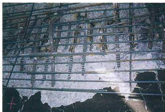
写真-7 圧接継手の破断 破断していないものは局部座屈
