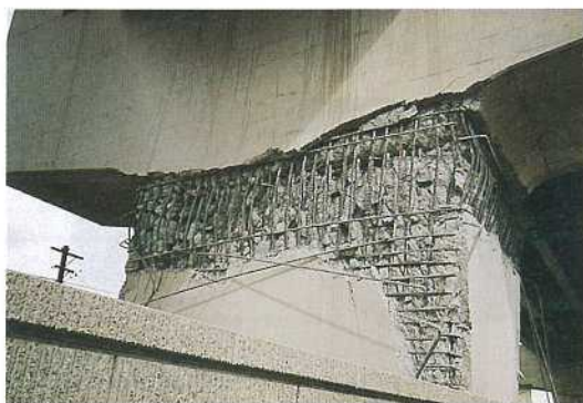
写真—15 全周に拡がった鉄筋の局部座屈
