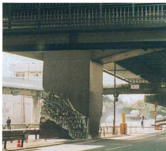
写真-8 矩形断面の橋脚 せん断びわれ
