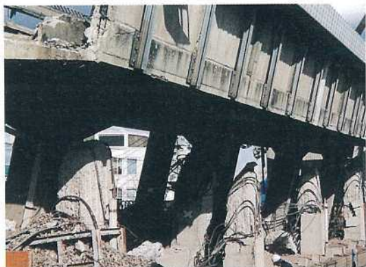
写真-2 上部が橋軸直角方向北側に落下
