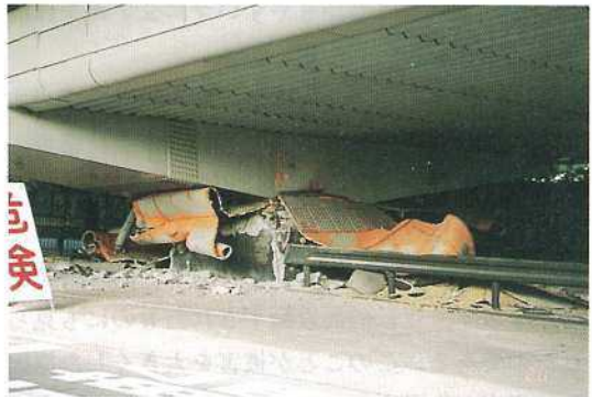
写真18 崩壊した鋼橋脚
