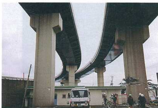
写真-10 単柱式橋脚の被害 段落とし部での鉄筋降伏
