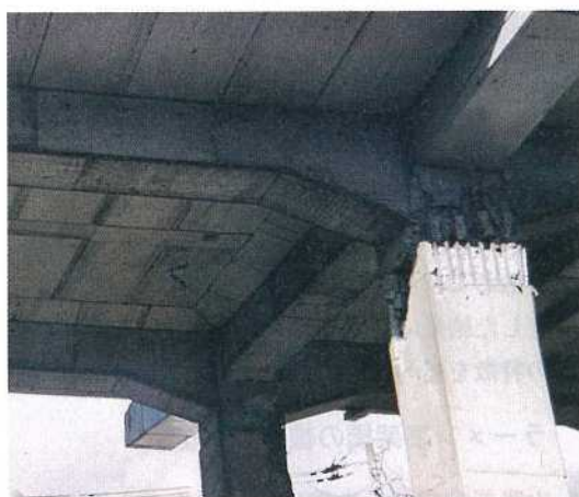
写真-3 中間ばりを有しないラーメン高架橋曲げ降伏後のせん断ひびわれ
