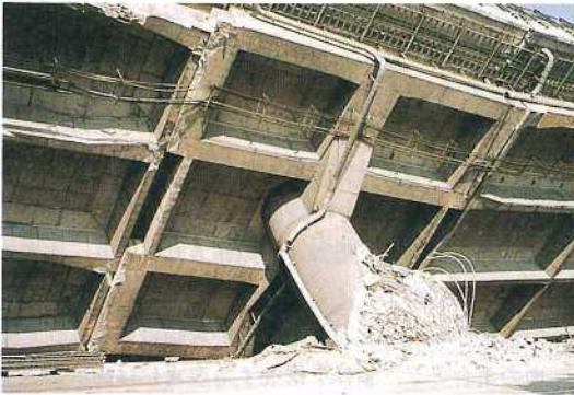
写真17 ビルツ橋脚の倒壊
