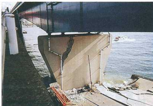
写真-12 第二摩耶大橋の橋脚 奇妙なひびわれ
