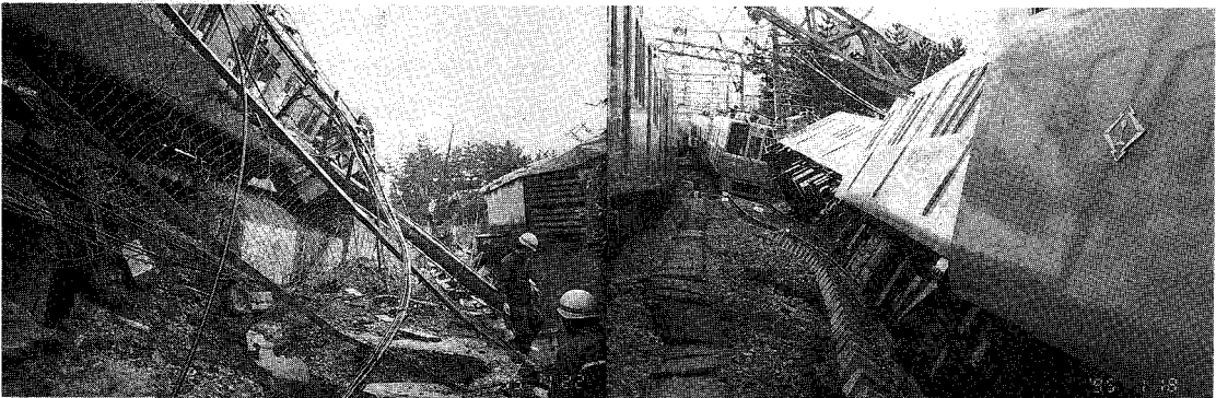
写真-1 擁壁盛土の崩壊
