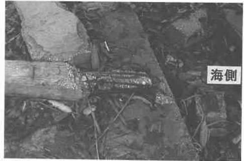
写真-3 大破した鉄筋コンクリート造の家屋
