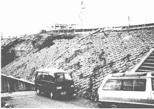
・格子砕工, 張りブロックが大きく変形 写真 4. 2. 3-1 被災直後の海側のり面
