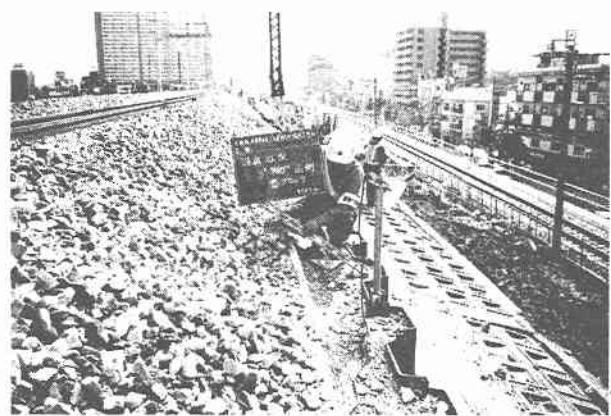
・仮復旧時の沈下状況(50cm～80cm 程度) 写真 4. 2. 3-6 山側のり肩沈下状況
