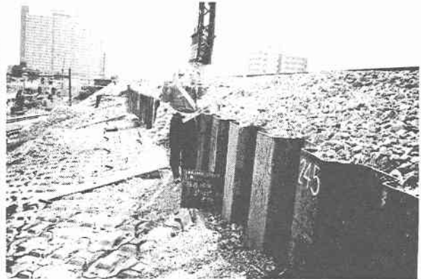
・想定沈下量 100cm 程度(シートパイルから想定) 写真 4. 2. 3-4 海側のり肩の沈下状況
