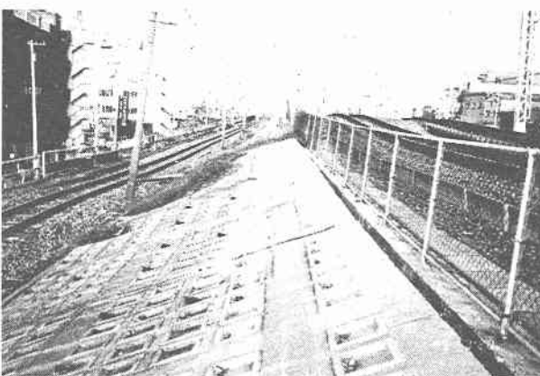
・被災直後の沈下状況(海側より小さい) 写真 4. 2. 3-5 山側のり肩の沈下状況
