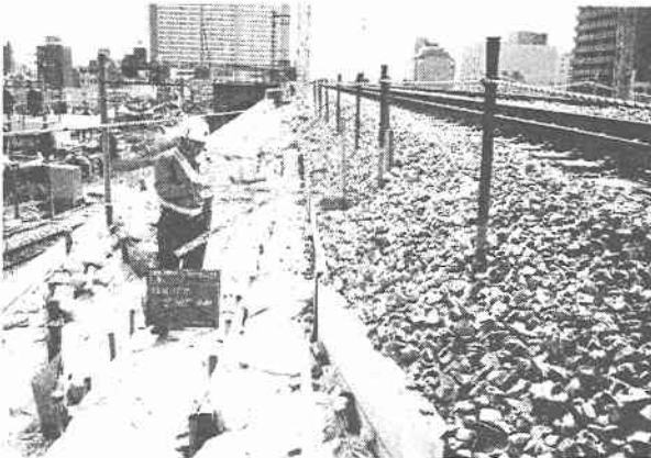
・被災直後の沈下状況(バラスト止めの落ち込み) 写真 4. 2. 3-3 海側のり肩の沈下状況
