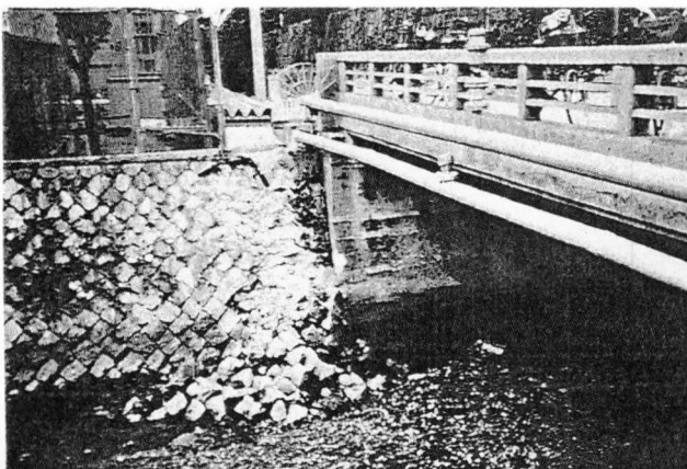
(a) パイプビーム橋台部の破損
