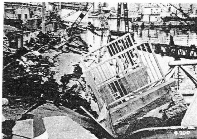
(b) 三角トラス橋台部転倒状況
