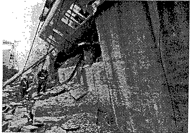
写真-4.6.2 重力式擁壁の被害状況
