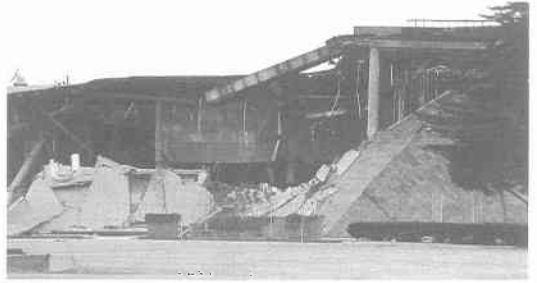
写真 8.2.11 デパートの内部被害状況 (写真 8.2.10 と同じ建物)
