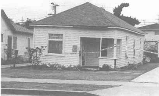
写真 8.2.21 木造住宅被害
