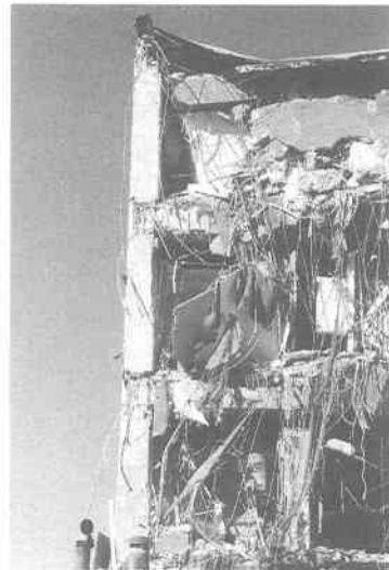
写真 8.2.26 5 階建て診療施設の妻壁部分の被害詳細 (写真 8.2.25 と同じ建物)
