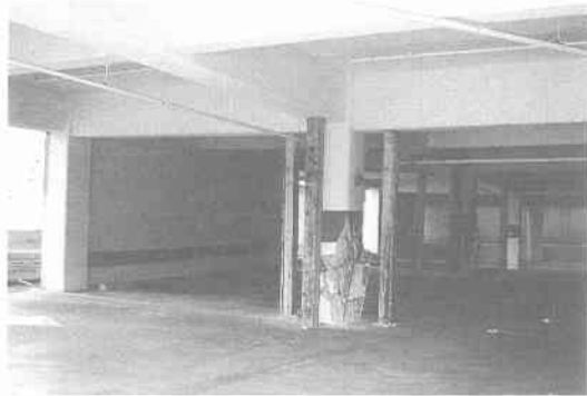
写真 8.2.7 1 層内柱のせん断破壊 (写真 8.2.6 と同じ駐車場)
