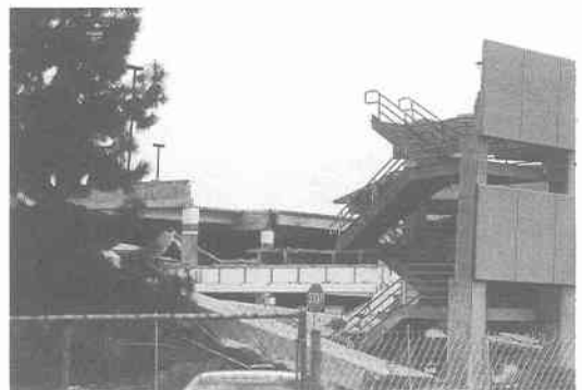
写真 8.2.4 2層プレキャストコンクリート造駐車場の崩壊 (Northridge Fashion Center / Parking)
