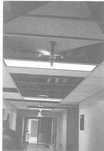
写真 8.2.42 スプリンクラーと天井との間で破損 (写真 8.2.41 と同じ建物)
