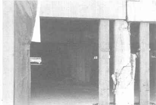
写真 8.2.9 せん断破壊した外周柱と無被害の内柱 (写真 8.2.8 と同じ駐車場)
