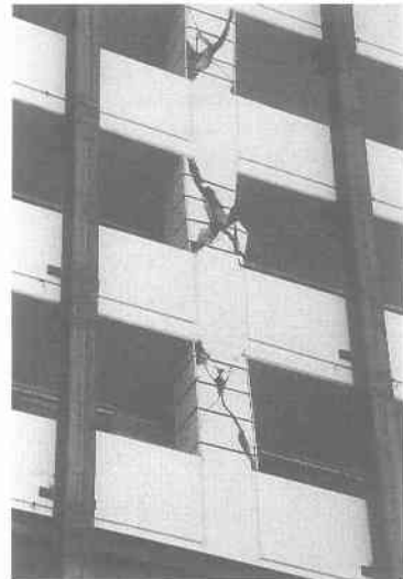
写真 8.2.32 中層以下の階の柱のせん断破壊 (写真 8.2.31 と同じ建物)
