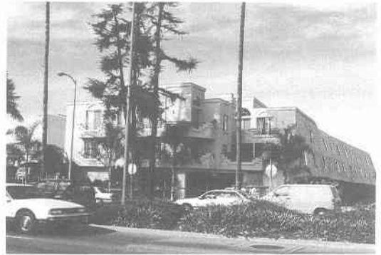
写真 8.2.20 3階建てアパートの脆弱な1層の被害 (1層鉄筋コンクリート造, 2~3層木造)
