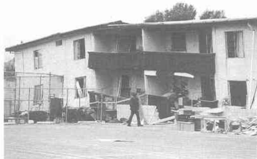
写真 8.2.18 3階建ての木造アパートの被害 (Northridge Meadows)
