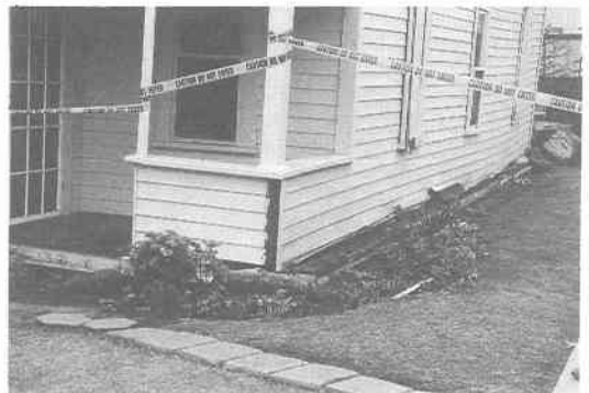
写真 8.2.22 木造住宅のクリップル・ウォール被害 (写真 8.2.21 と同じ建物)
