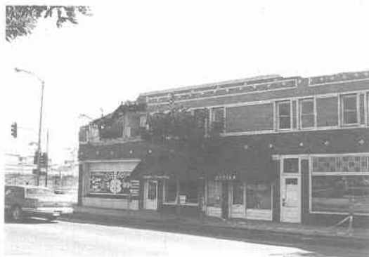
写真 8.2.44 サンタ・モニカ通り沿いの耐震補強された煉瓦造建物の被害
