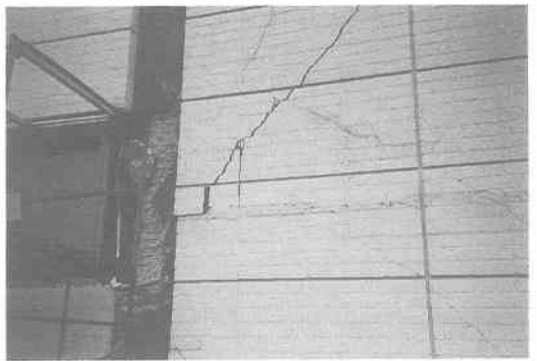
写真 8.2.15 デパートの外壁と2階外柱の被害 (写真 8.2.14 と同じ建物)
