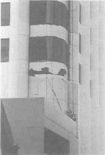
写真 8.2.35 高層ビル下層部の柱・壁の亀裂剥落 (写真 8.2.34 の奥の建物)
