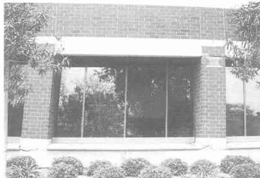
写真 8.2.40 1階柱の水平残留変形 (写真 8.2.39 と同じ建物)
