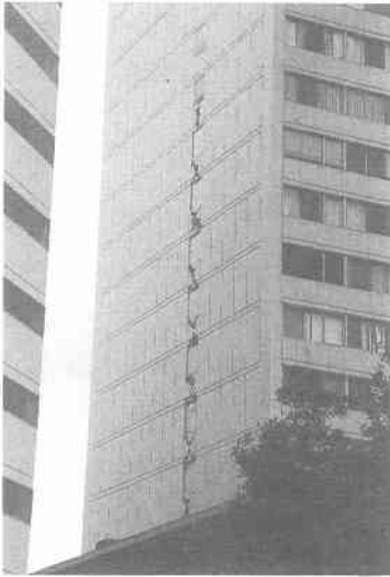
写真 8.2.33 連層壁をつなぐ短いはりのせん断破壊 (写真 8.2.31 と同じ建物)
