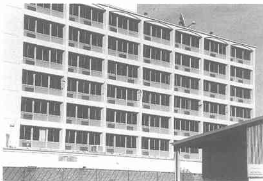
写真 8.2.28 ホテル南面 4 階部分の柱のせん断破壊 (写真 8.2.27 と同じ建物)
