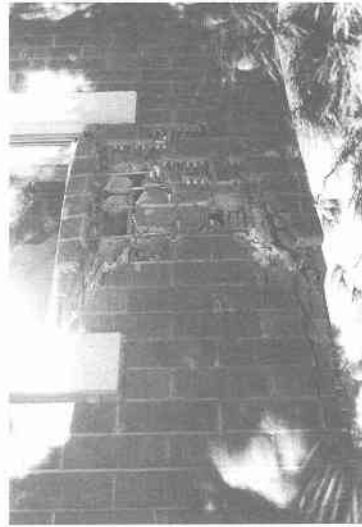
写真 8.2.46 補強煉瓦造建物の壁被害 (写真 8.2.45 と同じ建物)
