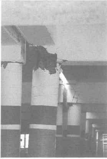
写真 8.2.5 鉄筋コンクリート造 1 層駐車場の柱の曲げ ヒンジ形成 (Northridge Fashion Center / Parking)
