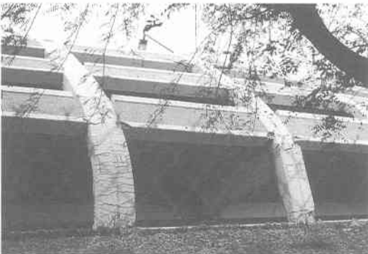
写真 8.2.3 外側柱の湾曲変形 (写真 8.2.1 と同じ駐車場)
