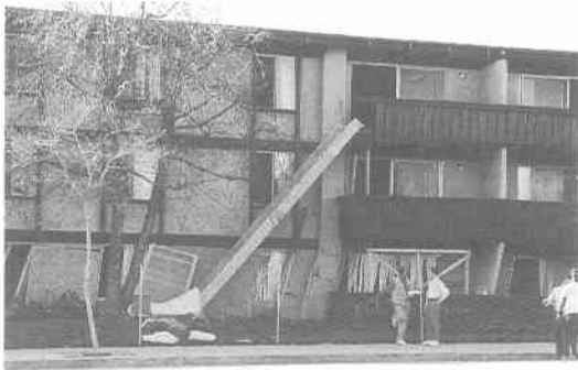
写真 8.2.17 3階建ての木造アパートの被害 (Northridge Meadows)
