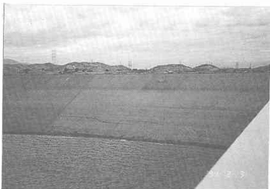
写真 4.3.7 上流斜面のクラック(ロサンジェルスダム)
