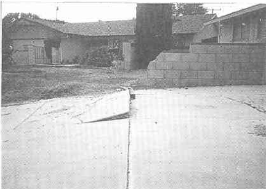
写真 4.4.14 舗装道路の変形とブロック塀の崩壊 (シミバレー)
