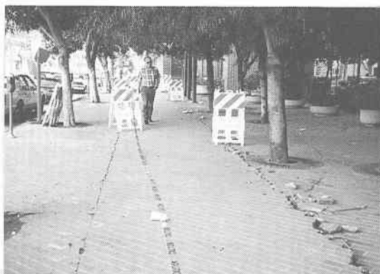
写真 4.3.29 舗道のクラック（スタジオシティ）
