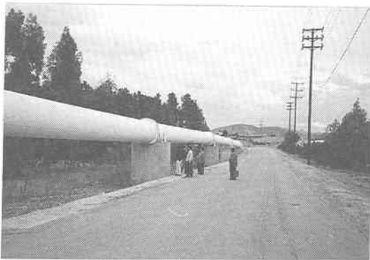
写真 4.3.12 管路の被害全景 (サンフェルナンド上ダム)
