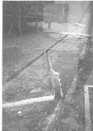
写真 4.4.15 液状化による住宅の床の亀裂 (シミバレー)
