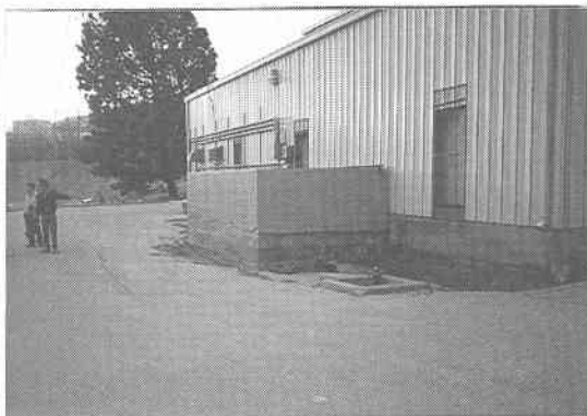
写真 4.3.10 発電所建物周辺の地盤沈下
