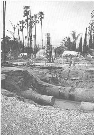
写真 4.3.26 水道管, ガス管の被害 (グラナダヒルズ)
