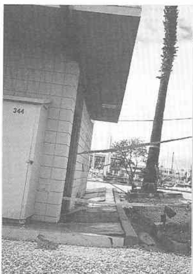
写真 4.4.1 液状化に伴う地盤沈下による建物の傾斜と変形（キングハーバー）
