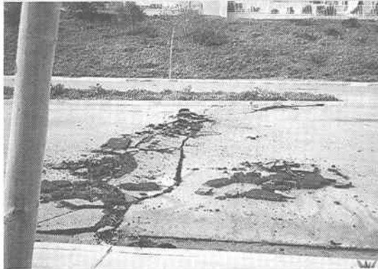
写真 4.4.5 道路を横切る地割れ (バレンシア)
