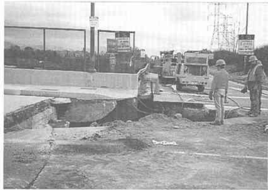
写真 4.3.27 洗い流された橋台裏込め盛土 (グラナダヒルズ)
