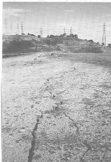
写真 4.3.3 サンフェルナンド下ダム 堤頂における地割れ
