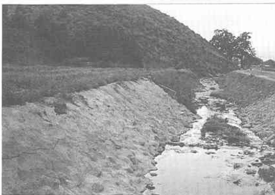
写真 4.4.10 メトロリンク シミバレー駅近くの 水路壁の亀裂
