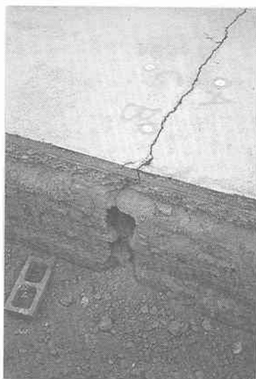
写真 4.3.8 北西側堤体の地割れ(ロサンジェルスダム)
