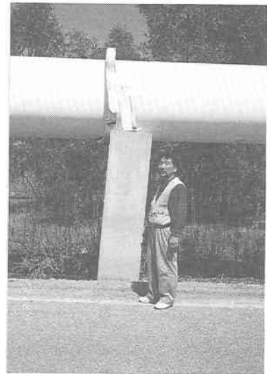
写真 4.3.13 支柱の側方変形による管路の被害 15)
