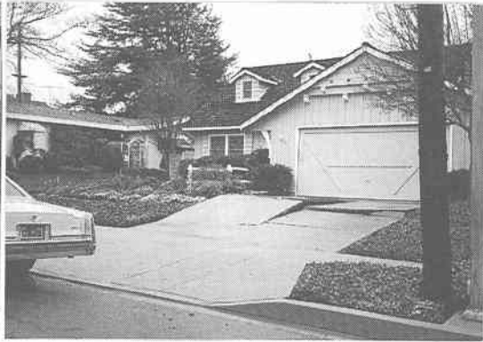
写真 4.3.25 圧縮による舗装の座屈 (グラナダヒルズ)
