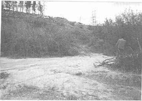
写真 4.3.4 サンフェルナンド下ダムの上流側法尻における噴砂
