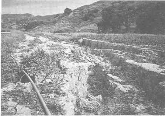
写真 4.4.12 メトロリンク シミバレー駅 近くの水路背後地盤の大きな亀裂
