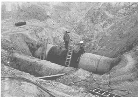
写真 4.3.21 破断した導管（ジェンセン浄水場） （MMD 提供）
