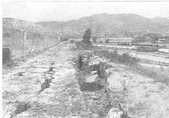
写真 4.3.20 斜面の地割れ（ジェンセン浄水場）
