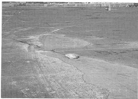
写真 4.4.4 液状化による駐車場舗装のクラック (サンタモニカ)
