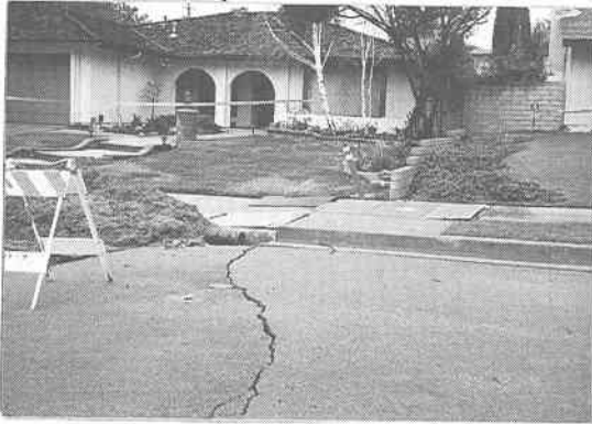
写真 4.3.24 舗装のクラック (グラナダ)
