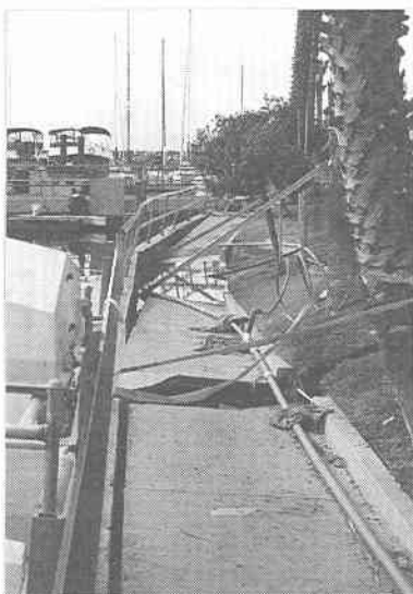
写真 4.4.2 護岸のはらみ出し（キングハーバー）
