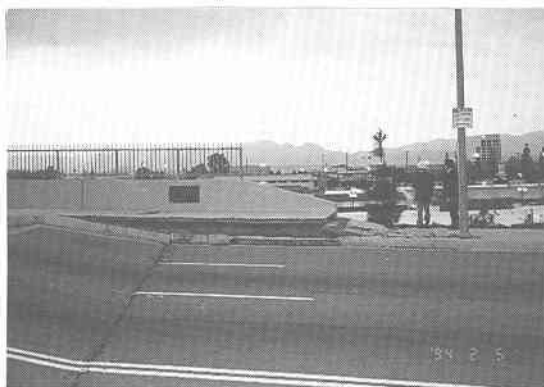
写真 4.3.28 橋台裏込めの沈下（ノースリッジ）
